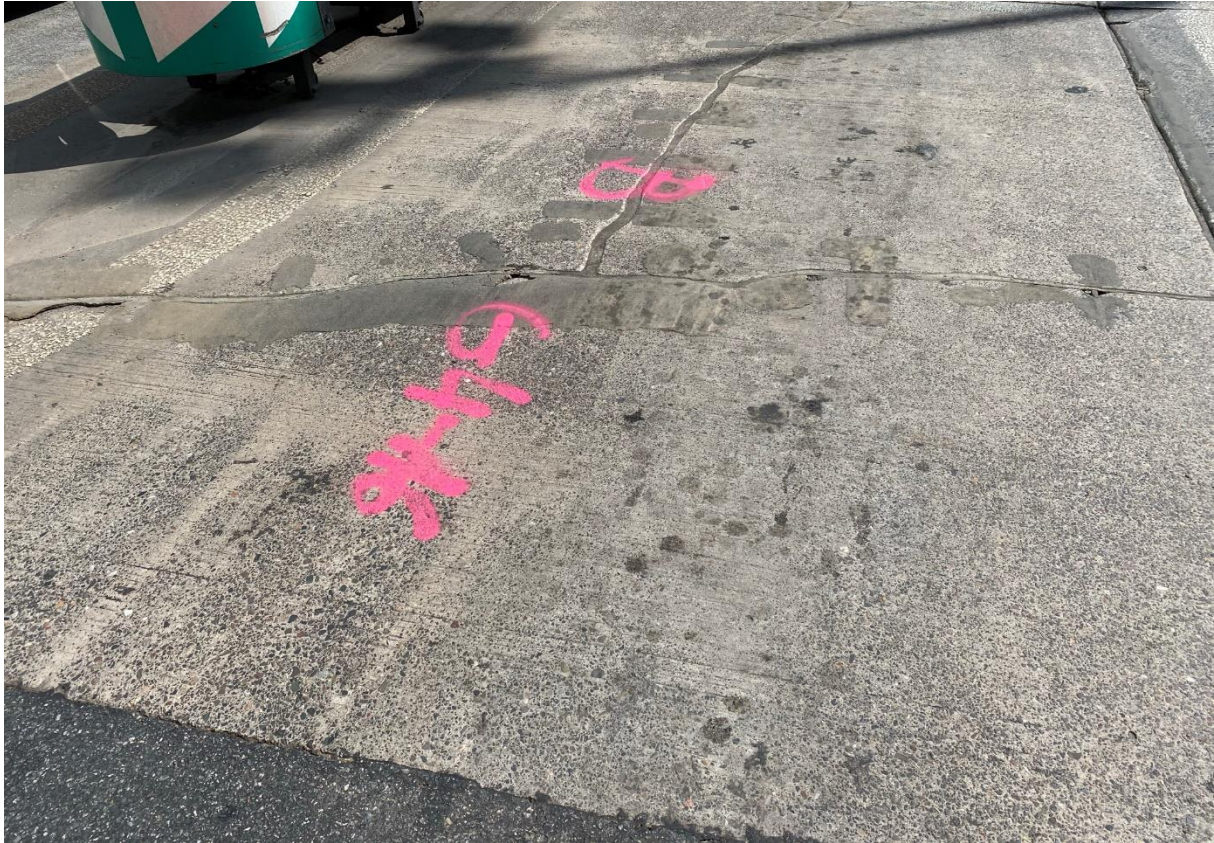
Zdj. 125 Pęknięcia poprzeczne i podłużne z naprawami płyty betonowej
