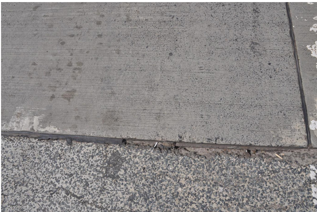
Zdj.7 Rozszczelnienie połączenia nawierzchni asfaltowej z betonową (całość).
