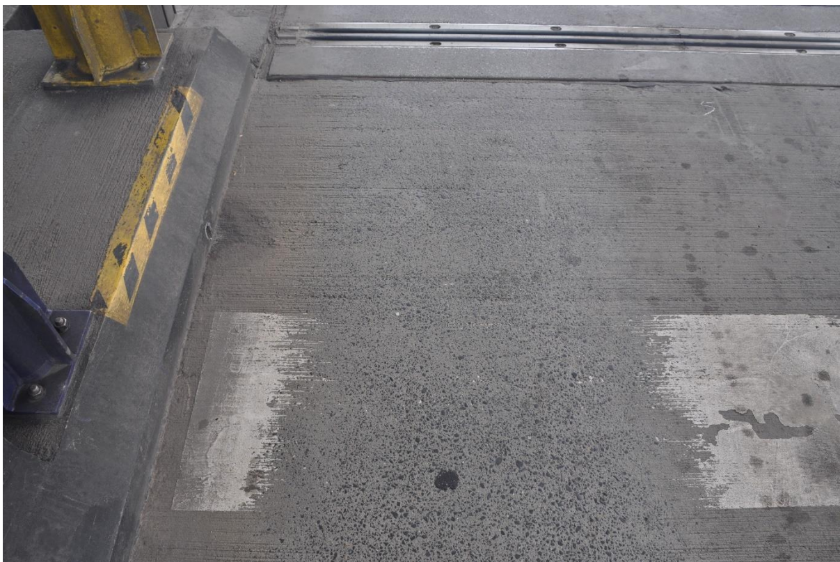
Zdj. 11 Wyżłobienia w powierzchni betonu w śladach przejazdu kół
