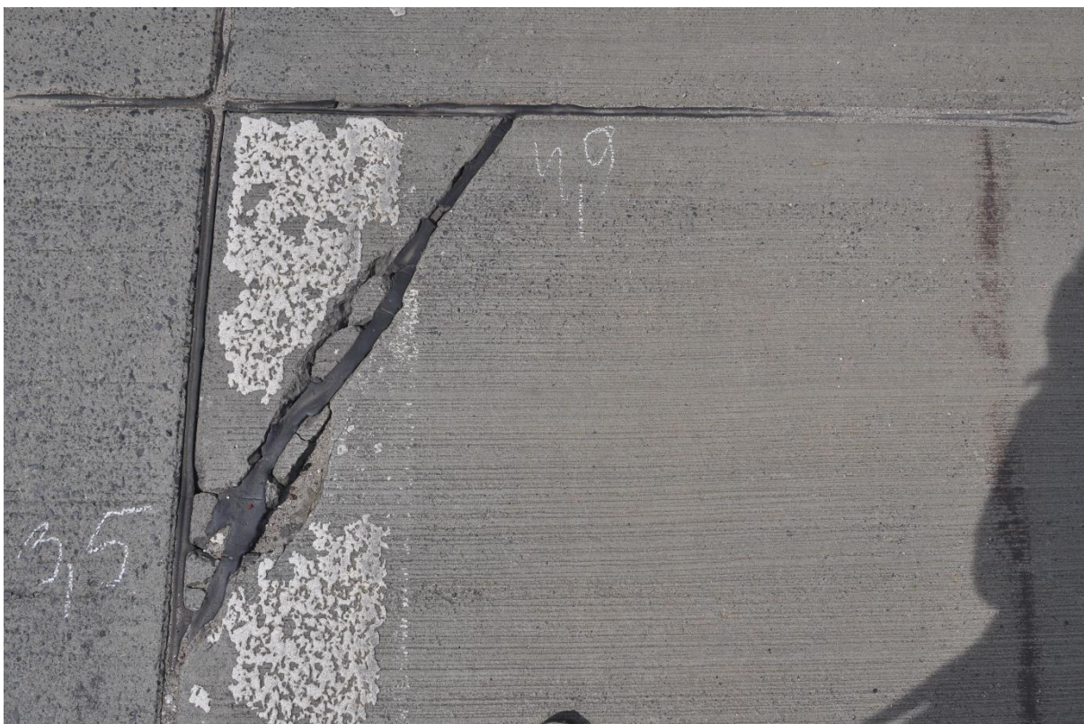
Zdj. 2 Odłamania naroży w śladzie przejścia kół pojazdów ciężkich
