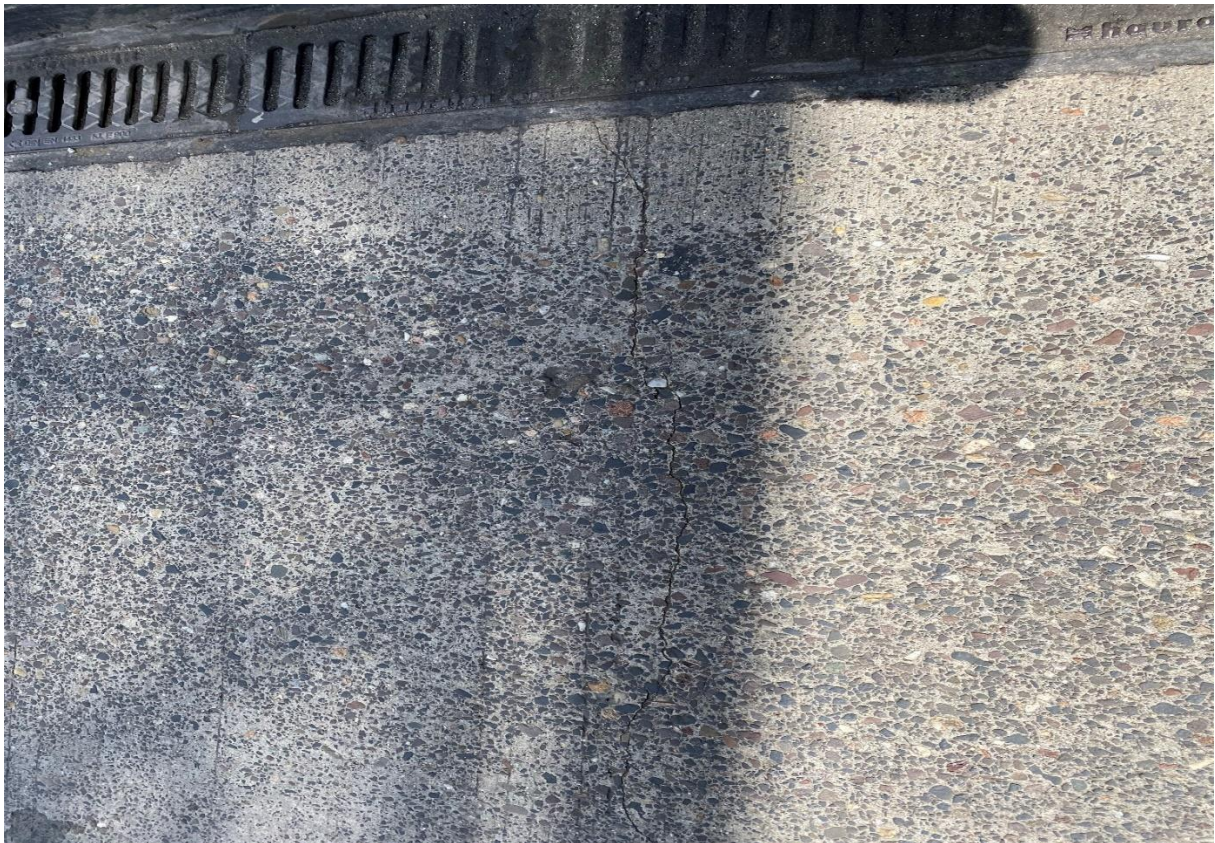
Zdj. 122 Spękania siatkowe na powierzchni betonu
