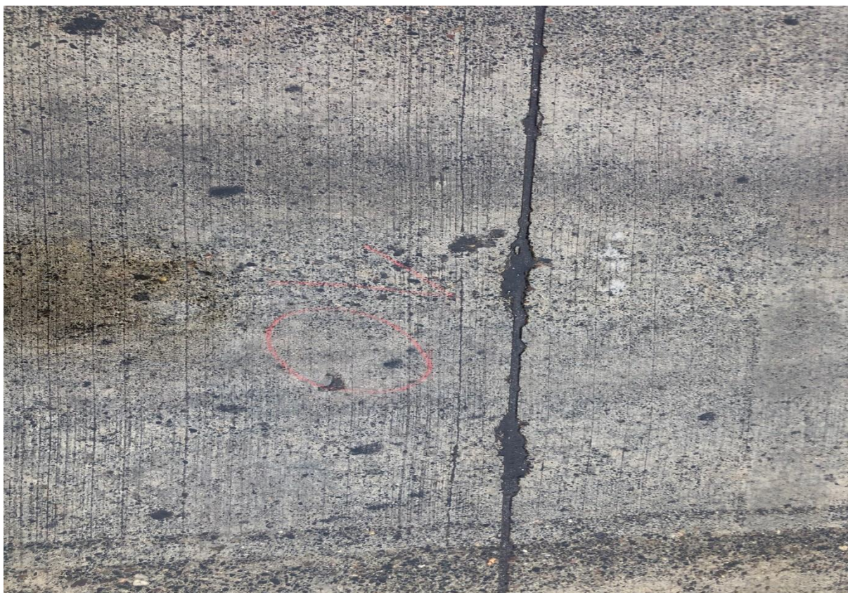
Zdj. 132 Rozszczelnienie szczelin między płytami betonowymi z naprawami krawędzi płyt
