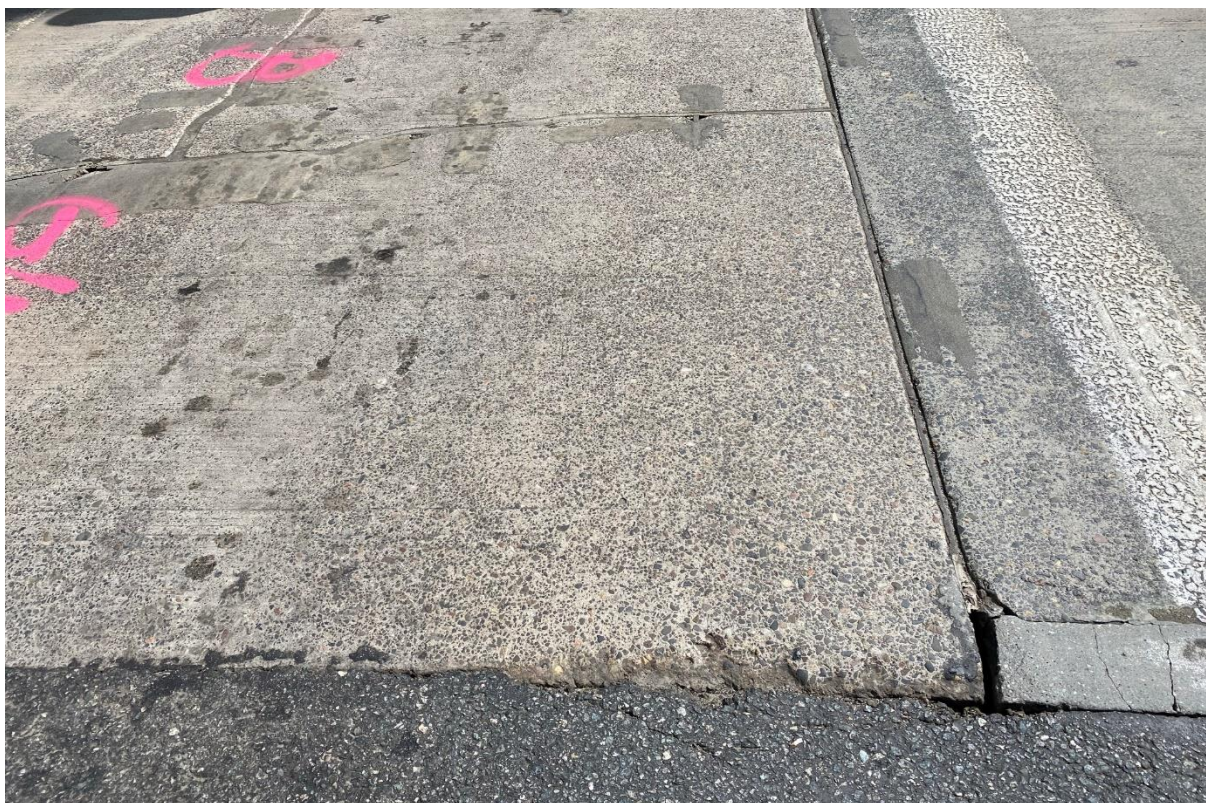
Zdj. 123 Rozszczelnienie szczelin między płytami betonowymi oraz przy połączeniu z powierzchnią asfaltową z wykruszeniami i pęknięciami
