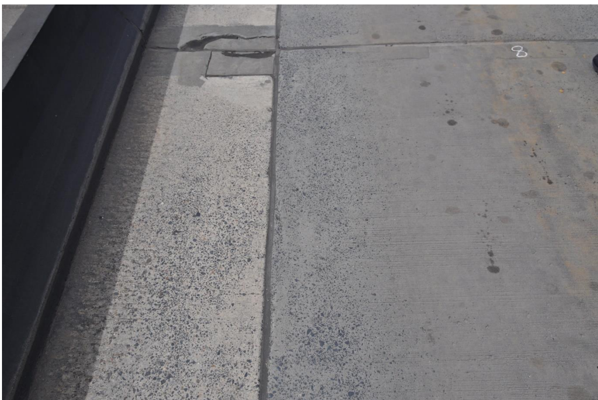
Zdj. 20 Odłamania w narożach płyt betonowych z przemieszczeniem betonu.
