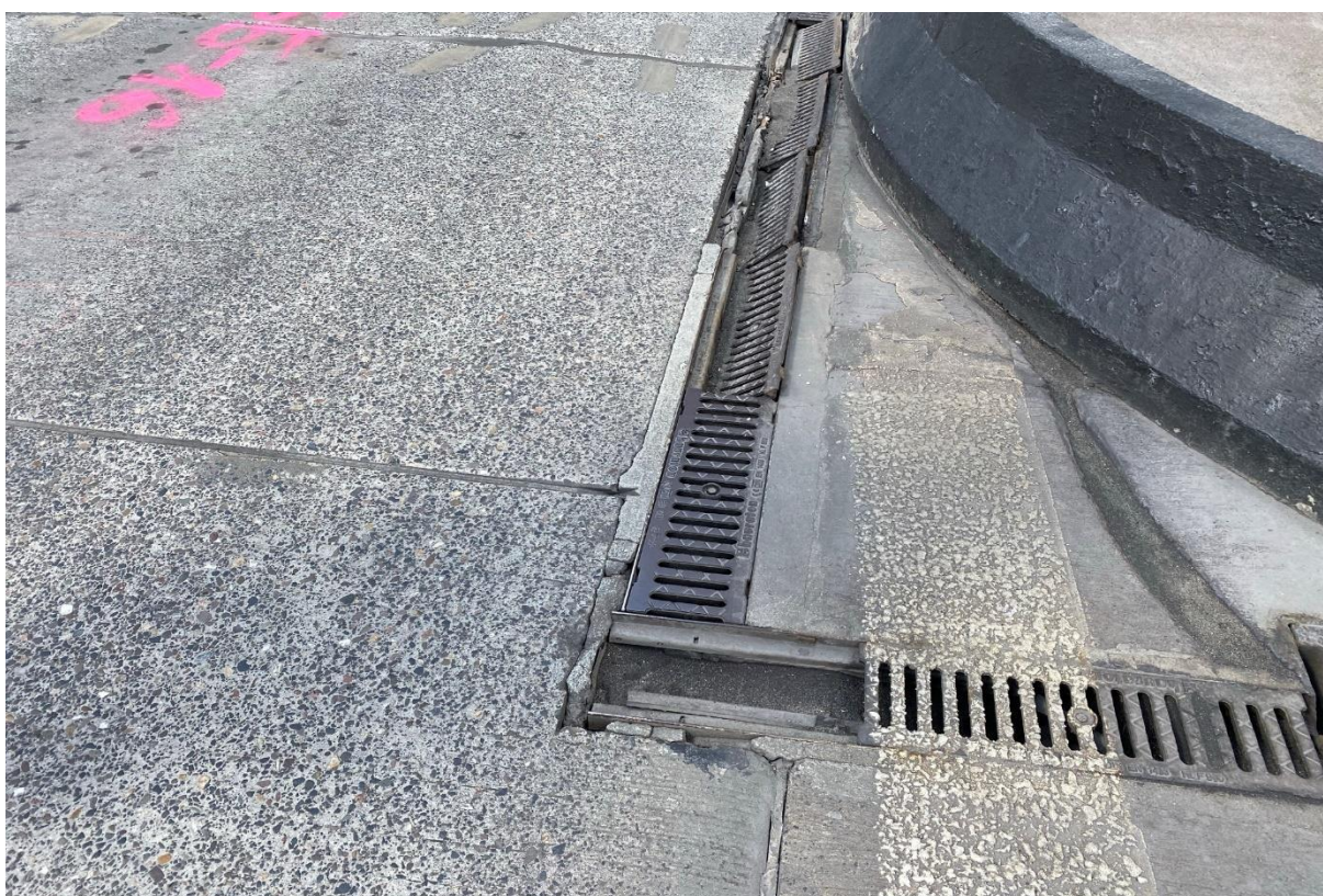
Zdj. 124 Uszkodzenie ścieku poprzecznego w nawierzchni betonowej z wykruszeniami na krawędziach płyty
