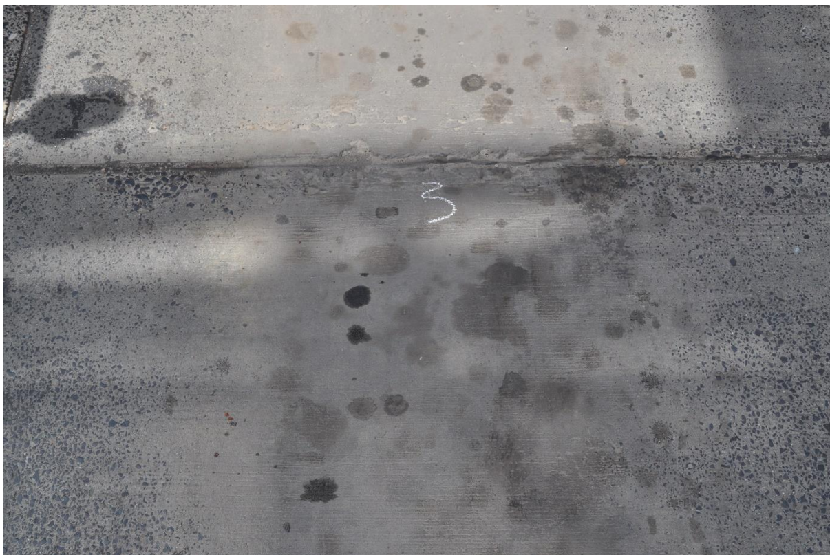
Zdj.15 Rozszczelnienie szczelin między płytami betonowymi z wykruszeniami betonu na krawędziach płyt
