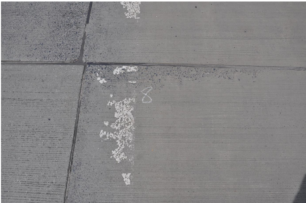
Zdj. 5 Rozszczelnienie szczelin między płytami betonowymi i wykruszenia betonu przy szczelinach
