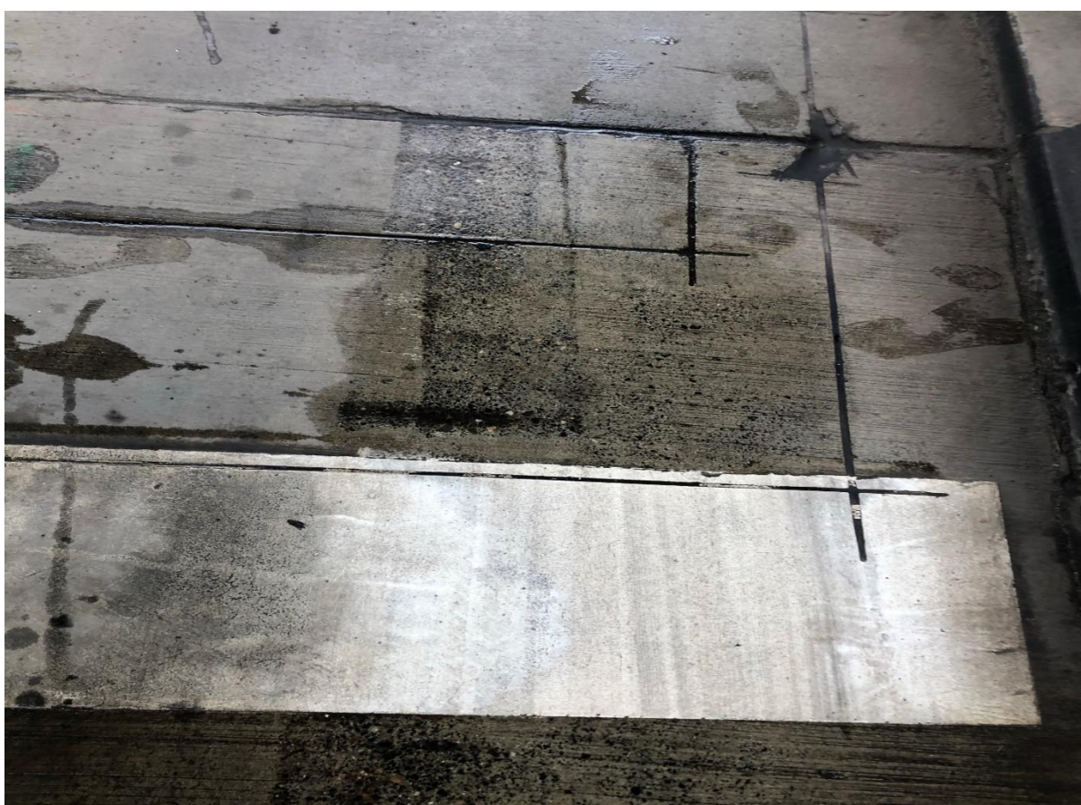
Zdj. 129 Rozszczelnienie miejsc ułożenia pętli indukcyjnych
