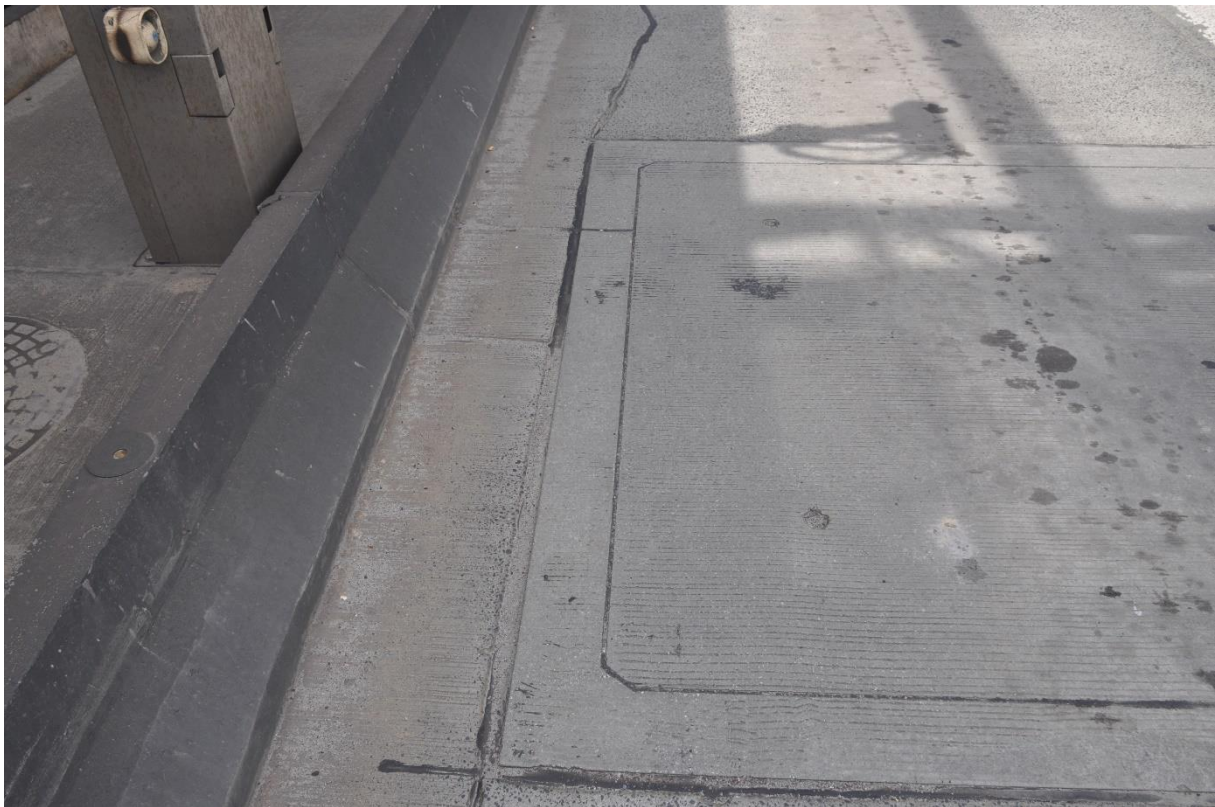
Zdj.9 Rozszczelnienie miejsc ułożenia pętli indukcyjnych
