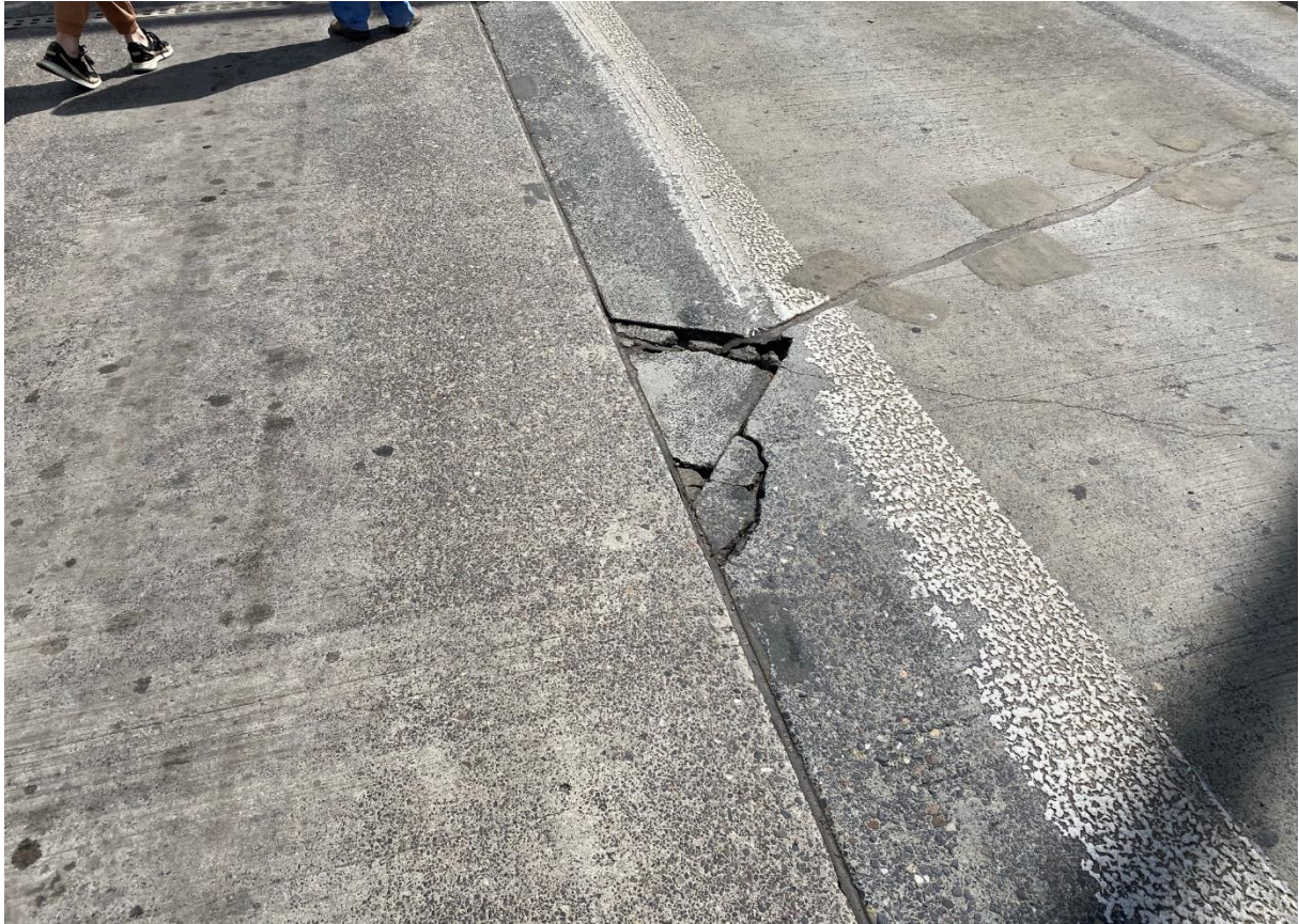
Zdj. 119 Pęknięcia wielokrotne z przemieszczaniami w płycie betonowej
