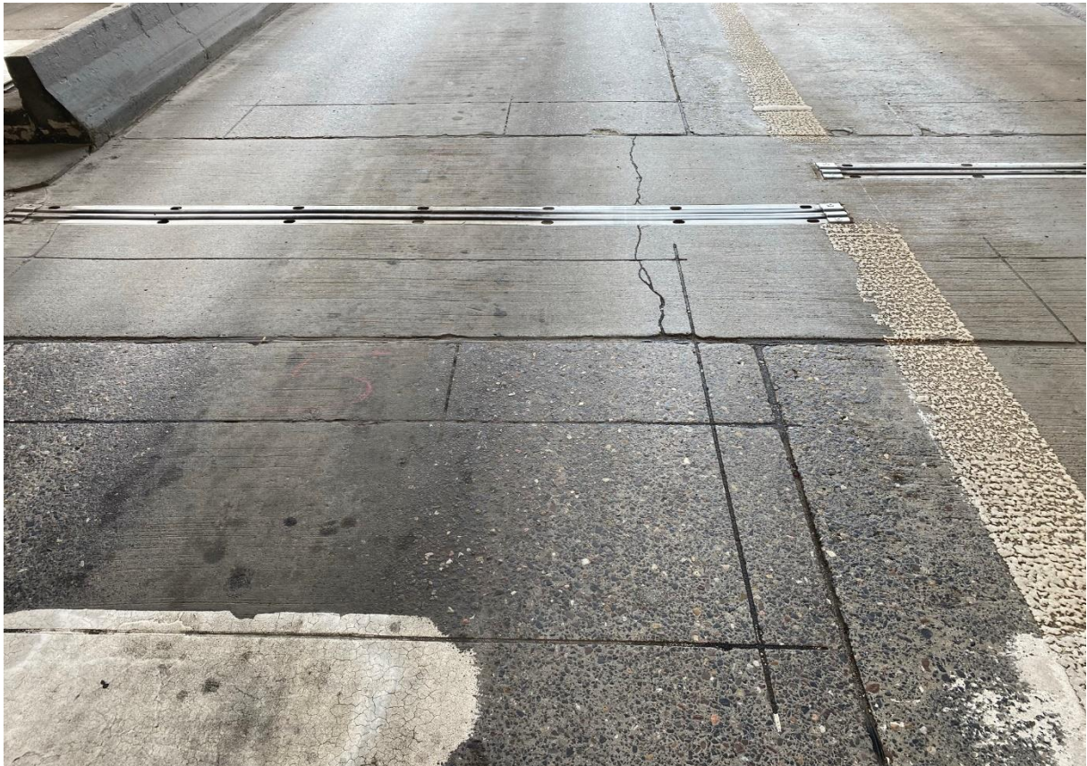
Zdj. 120 Rozszczelnienie miejsc ułożenia pętli indukcyjnych
