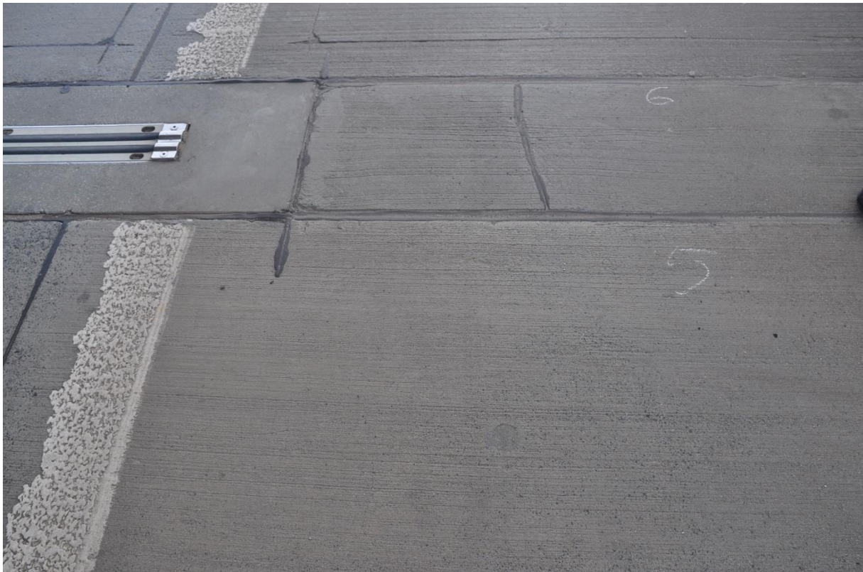
Zdj. 4 Pęknięcia płyt
