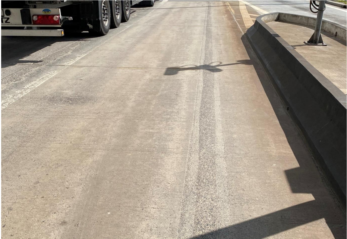
Zdj. 130 Wyżłobienia w powierzchni betonu w śladach przejazdu kół
