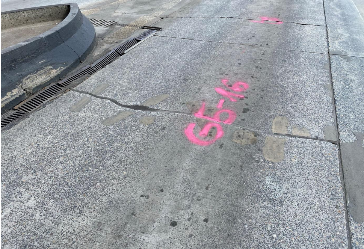
Zdj. 121 Wyżłobienia w powierzchni betonu w śladach przejazdu kół, pęknięcia i uszkodzenie ścieku podłużnego
