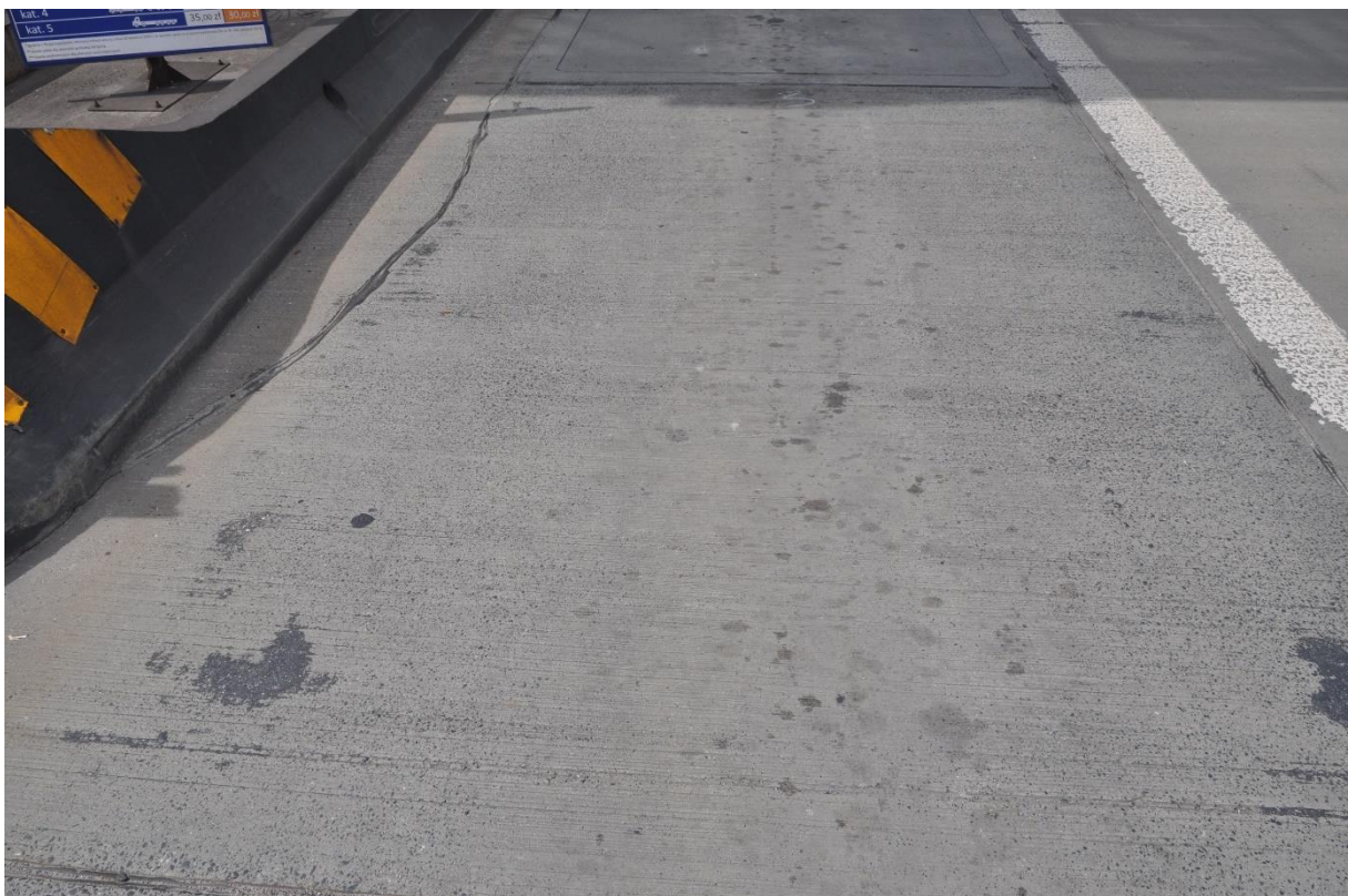
Zdj.10 Pęknięcia płyt
