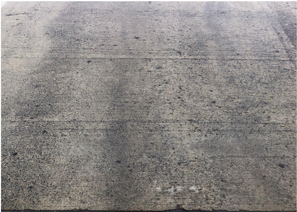
Zdj.131 Spękania siatkowe na powierzchni betonu
