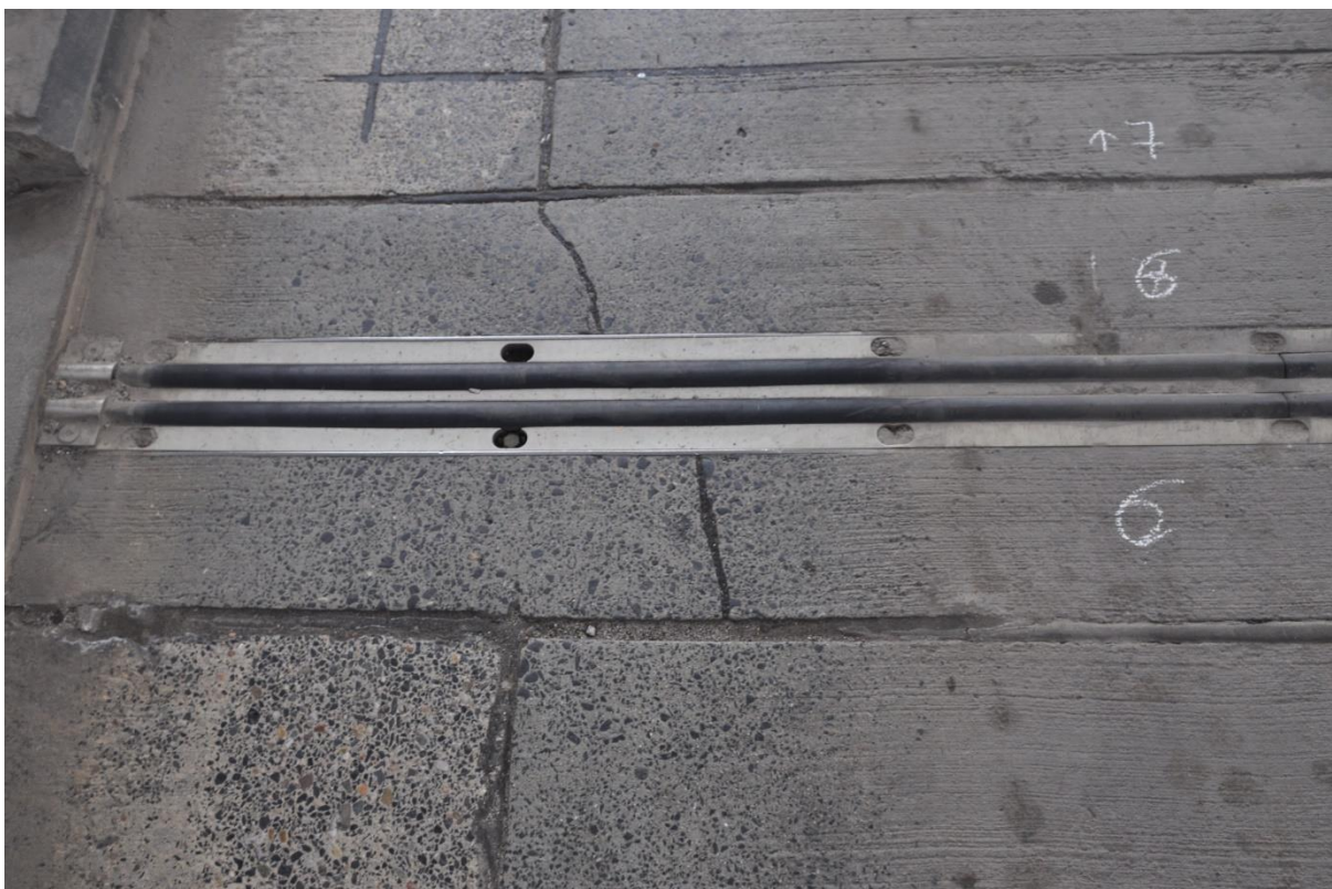
Zdj. 19 Pęknięcia płyt betonowej poprzeczne i podłużne.
