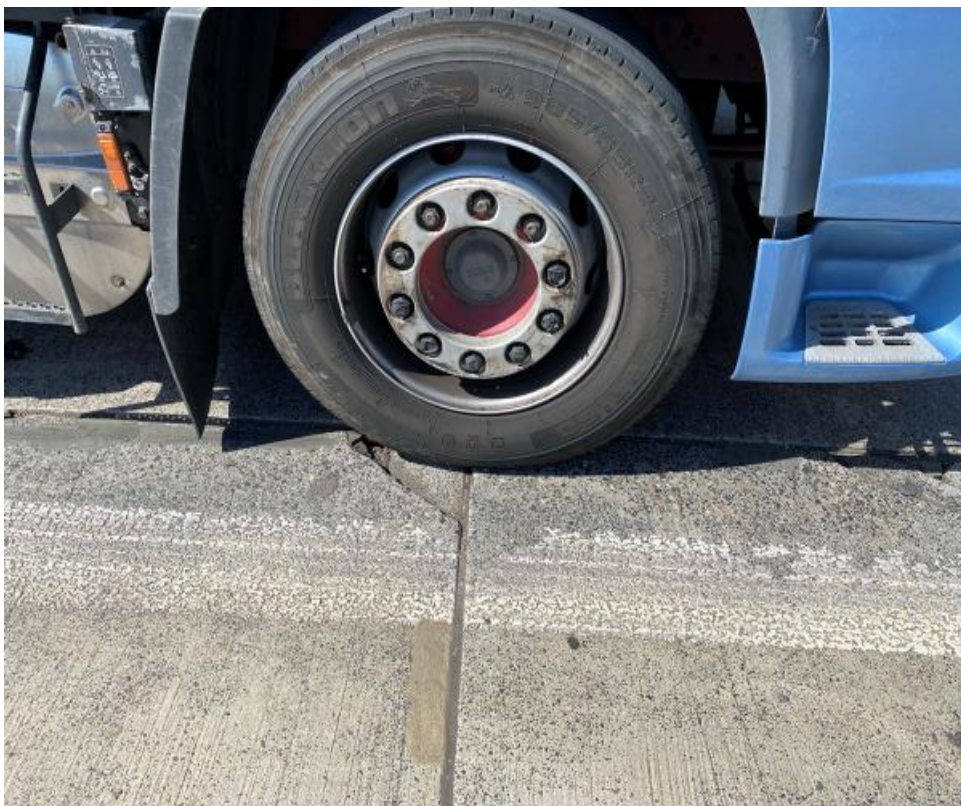
Zdj. 126 Pęknięcia wielokrotne z przemieszczaniami w płycie betonowej w ścieżce przejazdu kół pojazdów ciężkich
