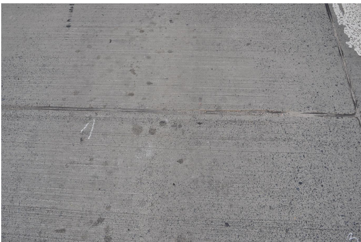
Zdj.8 Rozszczelnienie szczelin między płytami betonowymi z wykruszeniami betonu na krawędziach płyt (całość)
