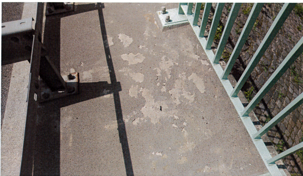
Zdj. 3. Obiekt M49L – nawierzchnia żywiczna kapy chodnikowej zewnętrznej, skorodowana stopka bariery energochłonnej
