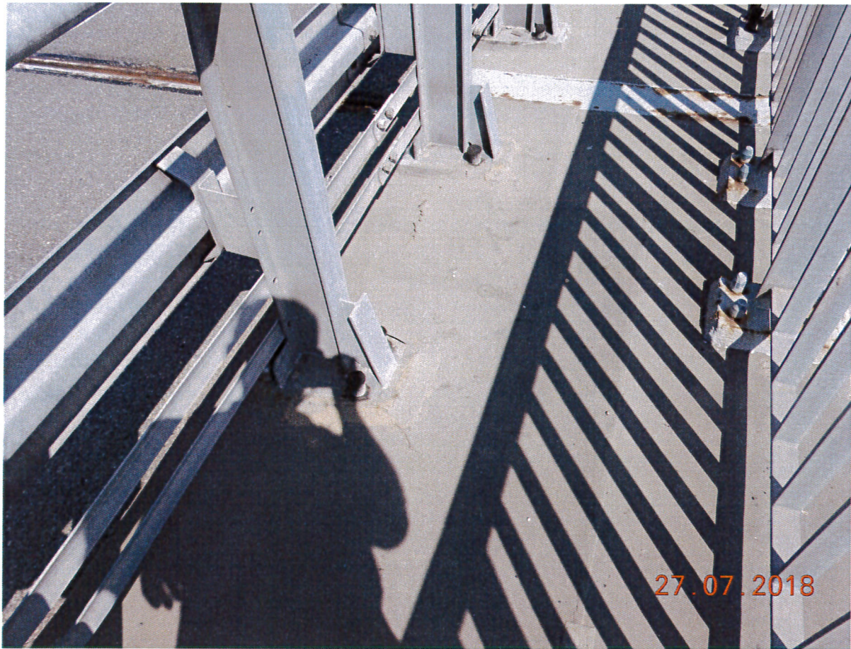
Zdj. 10. Obiekt M55P – nawierzchnia kapy chodnikowej zewnętrznej, skorodowana blacha ostonowa urządzenia dylatacyjnego, skorodowane stopki balustrady
