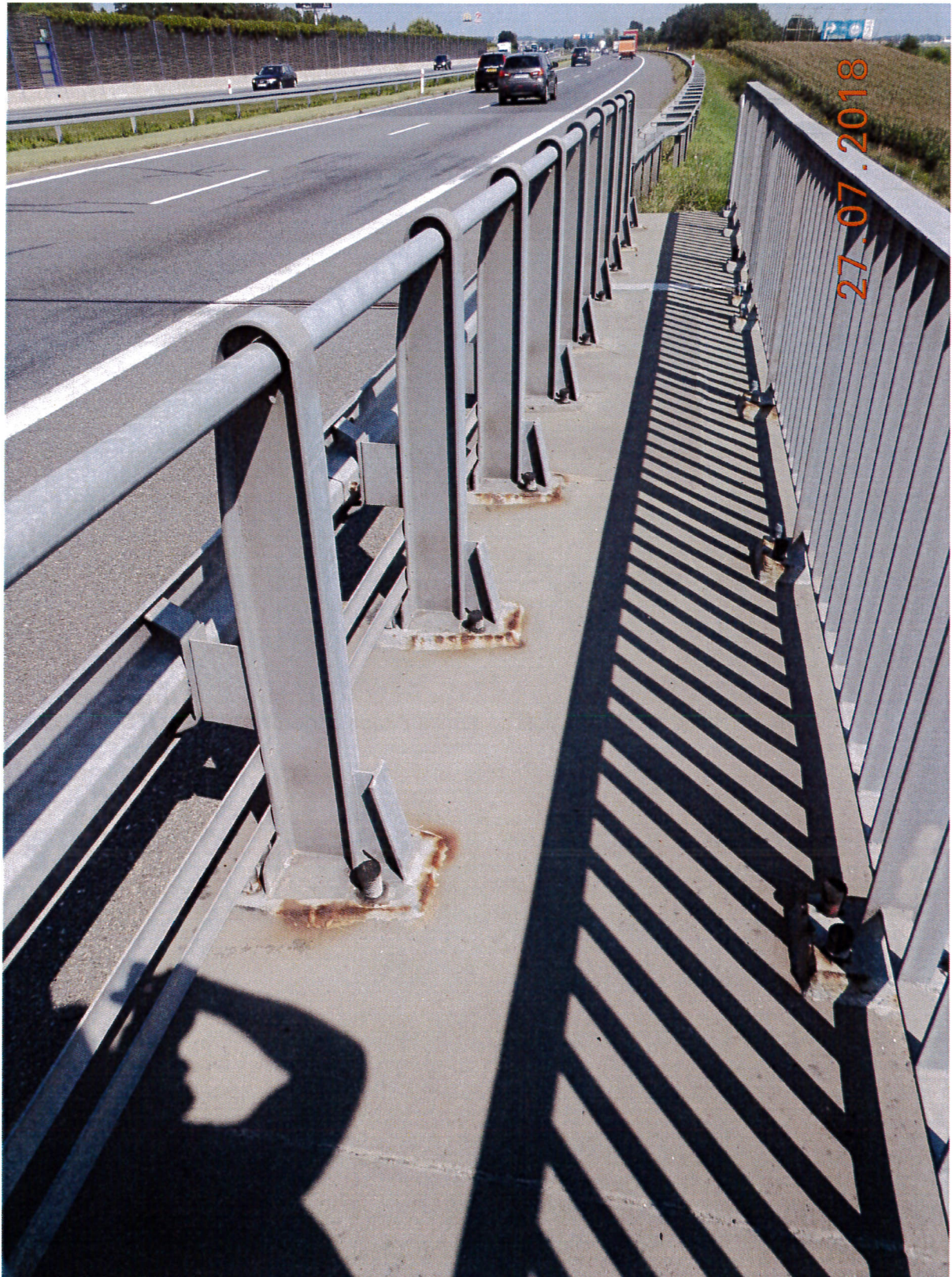
Zdj. 9. Obiekt M55P – skorodowane blachy podstawy słupków barieroporeczy i balustrady
