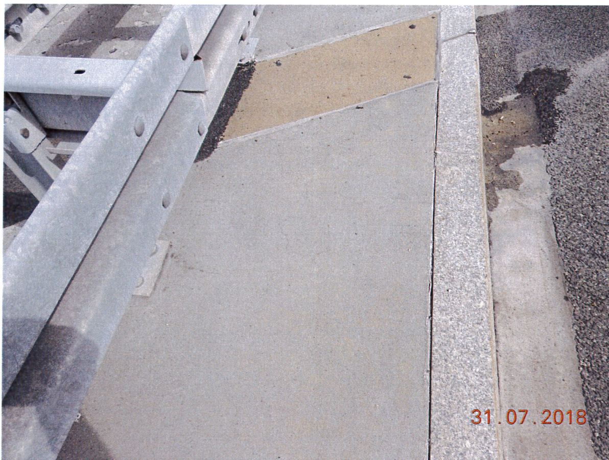
Zdj. 7. Obiekt M52P – styk krawężnika z kapą chodnikową do uszczelnienia
