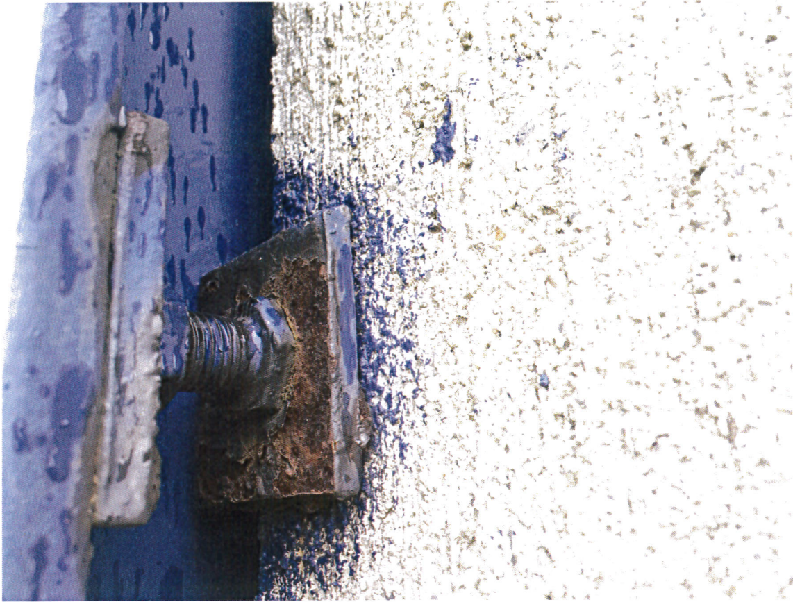
Fot.10. Skorodowany łącznik mocujący.
