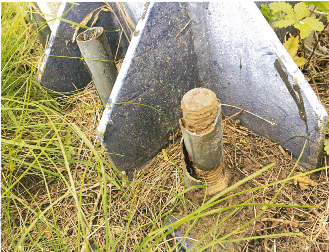
Fot.6. Skorodowane kotwy stalowe wraz z zanieczyszczoną podstawą słupa stalowego.
