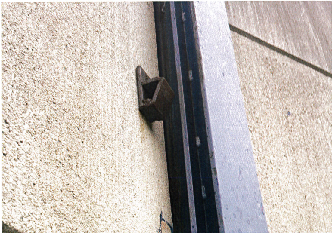
Fot.11. Nieprawidłowa lokalizacja łączników mocujących płyty (nie przylega do słupa).
