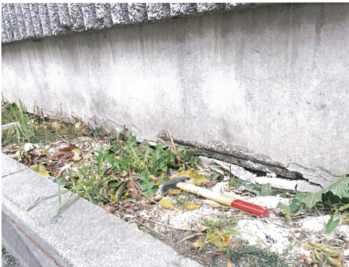
Fot.7. Liczne pęknięcia wzdłuż dolnej krawędzi podwaliny, odsłonięte zbrojenie.
