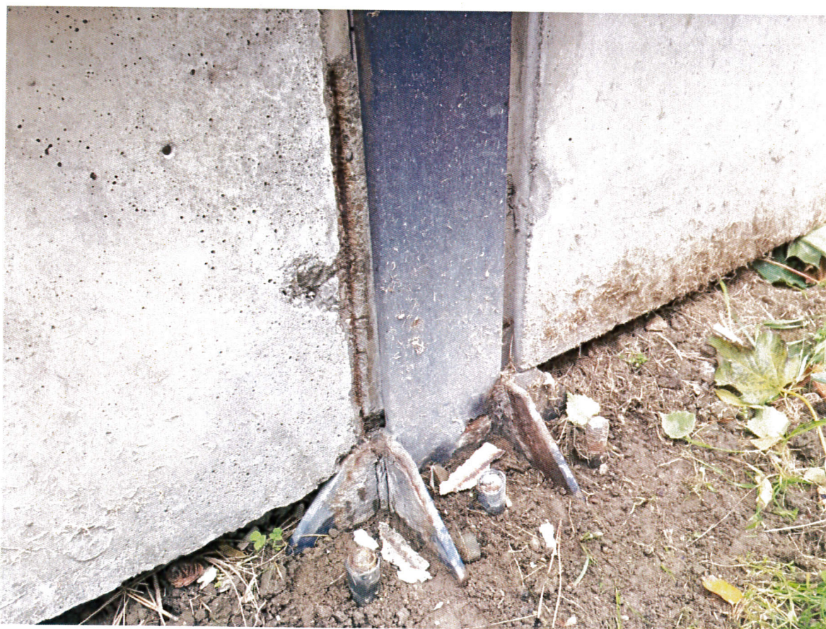
Fot.9. Skorodowany słup stalowy i jego podstawa.
