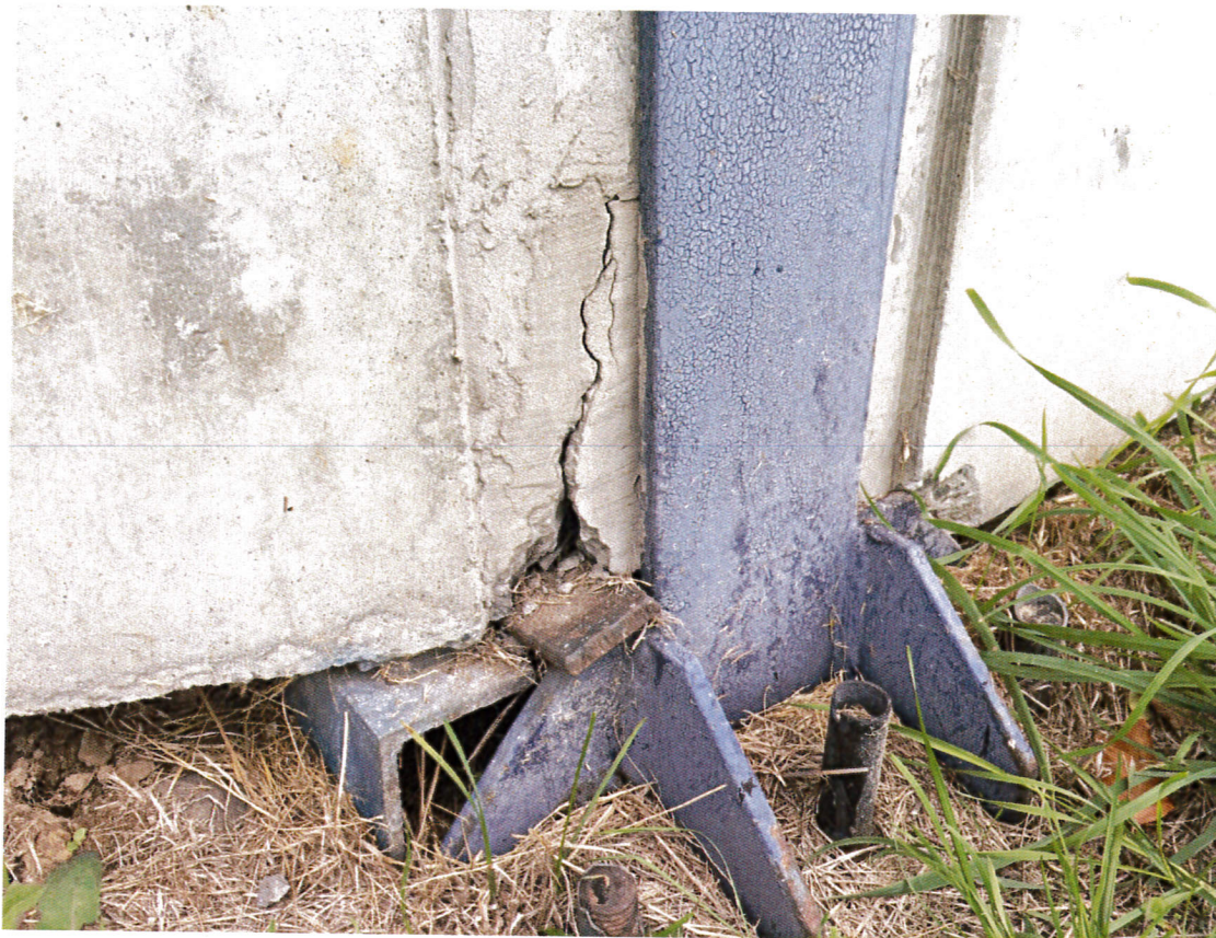
Fot.8. Pęknięcie belki podwalinowej. Zanieczyszczona podstawa słupa.
