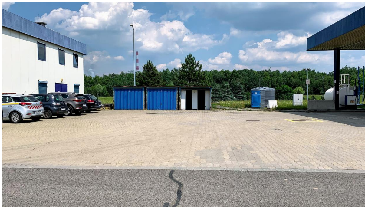
Fot. 7 Stanowiska postojowe/plac przy budynku warsztatu oraz stacji paliw – strona prawa jezdni (oś C-D) – nierównomierne osiadania
