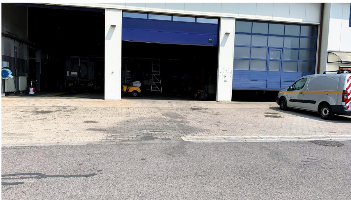
Fot. 6 Stanowiska postojowe/plac przy budynku warsztatu – strona prawa jezdni (oś C-D) – nierównomierne osiadania, zabrudzenia
