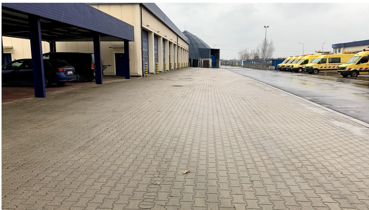
Fot. 4 Stanowiska postojowe/plac przy budynku garaży – strona lewa jezdni (oś A-B) – nawierzchnia lokalnie popękana, zabrudzenia
