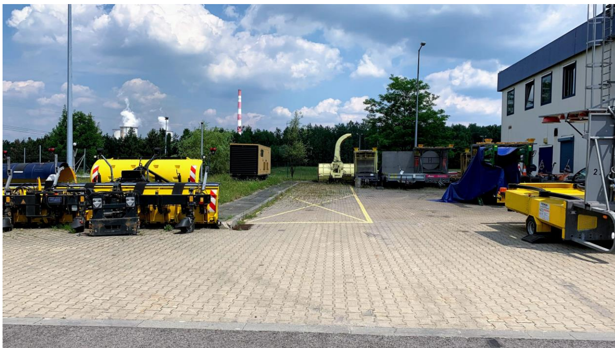
Fot. 5 Stanowiska postojowe/plac przy budynku warsztatu – strona prawa jezdni (oś C-D) – nierównomierne osiadania, porośnięte trawą, zabrudzenia
