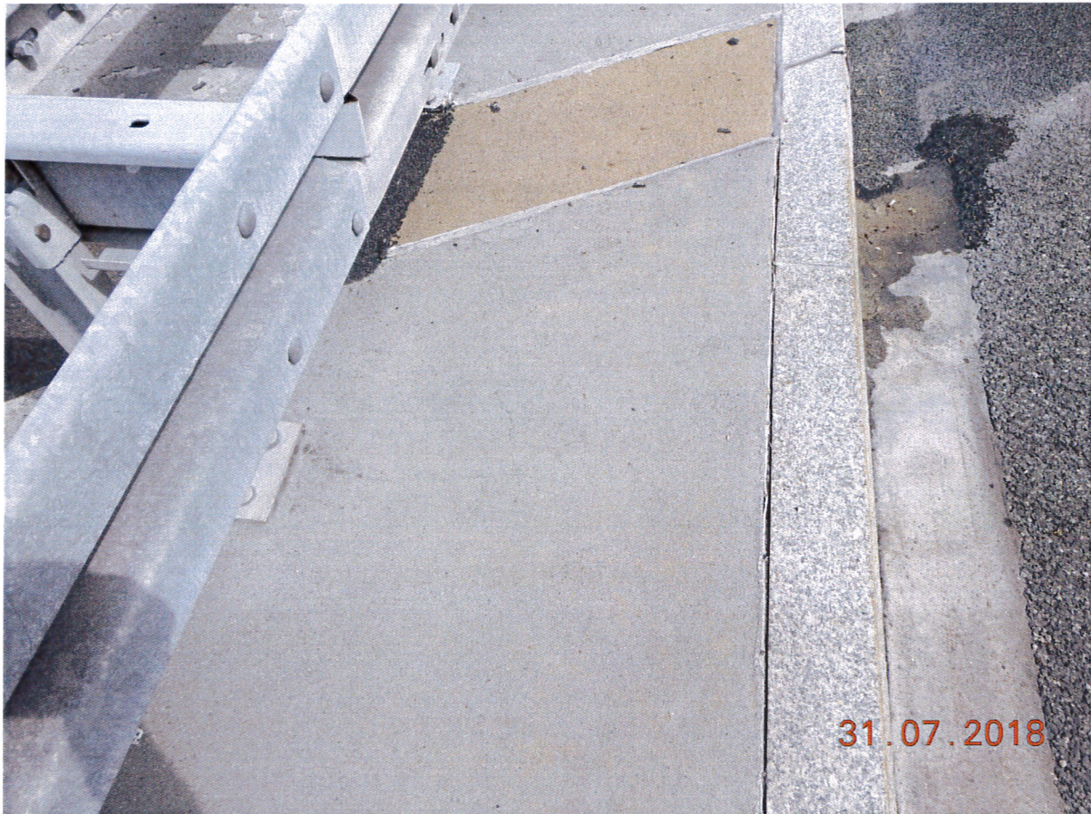
Zdj. 9. Obiekt M52P – styk krawężnika z kapą chodnikową do uszczelnienia
