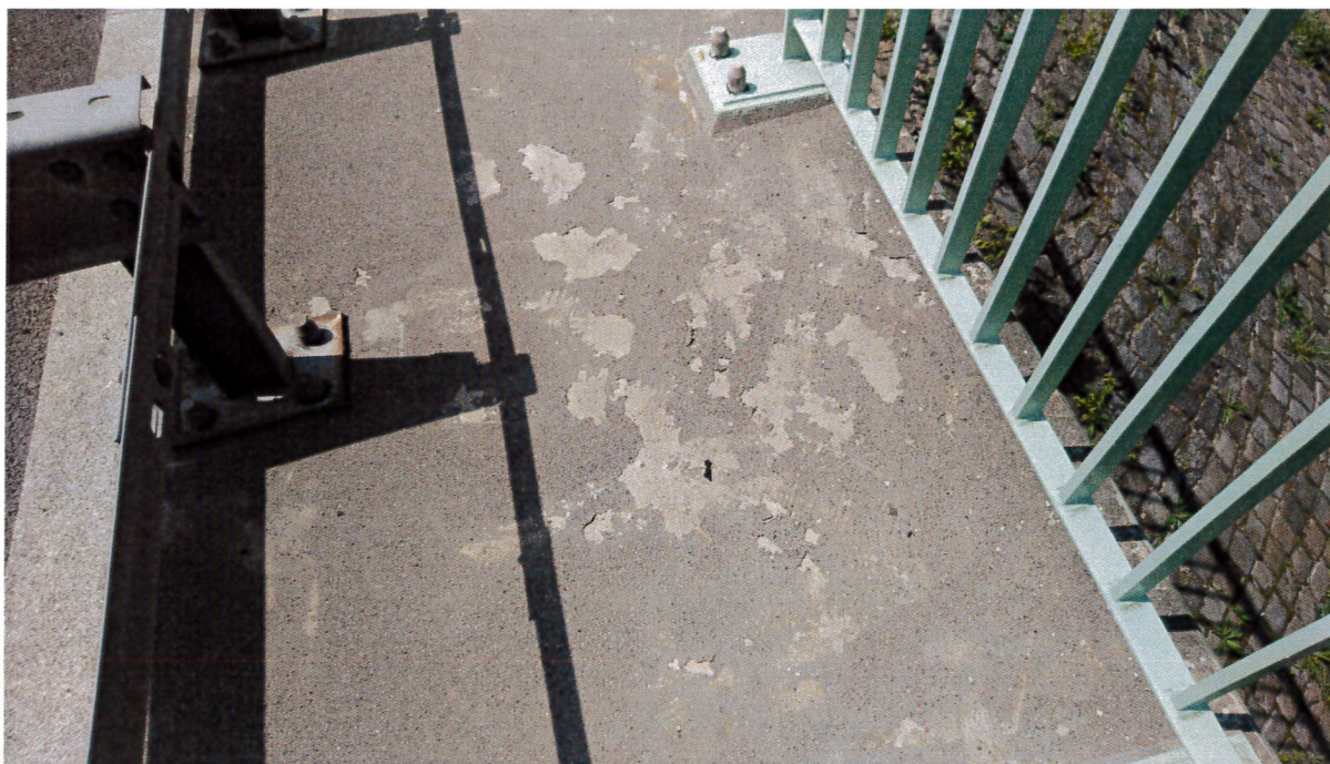
Zdj. 5. Obiekt M49L – nawierzchnia żywiczna kapy chodnikowej zewnętrznej, skorodowana stopka bariery energochłonnej
