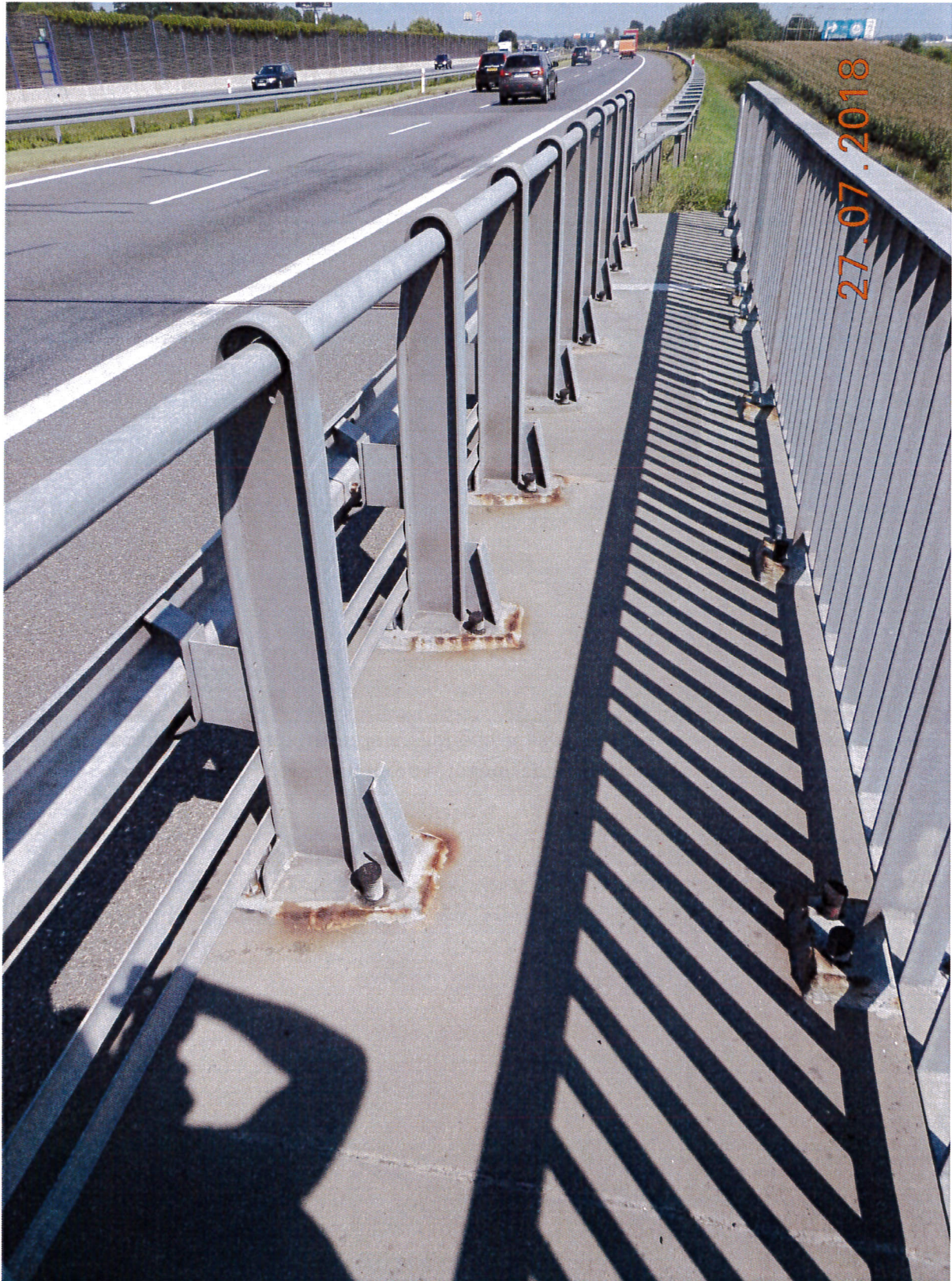
Zdj. 11. Obiekt M55P – skorodowane blachy podstawy słupków barieroporeczy i balustrady
