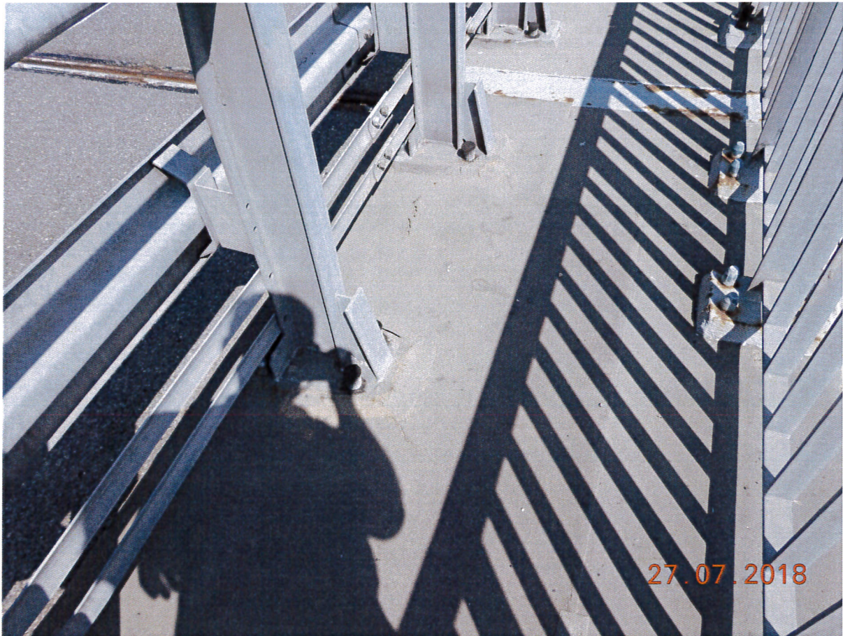
Zdj. 12. Obiekt M55P – nawierzchnia kapy chodnikowej zewnętrznej, skorodowana blacha osłonowa urządzenia dylatacyjnego, skorodowane stopki balustrady
