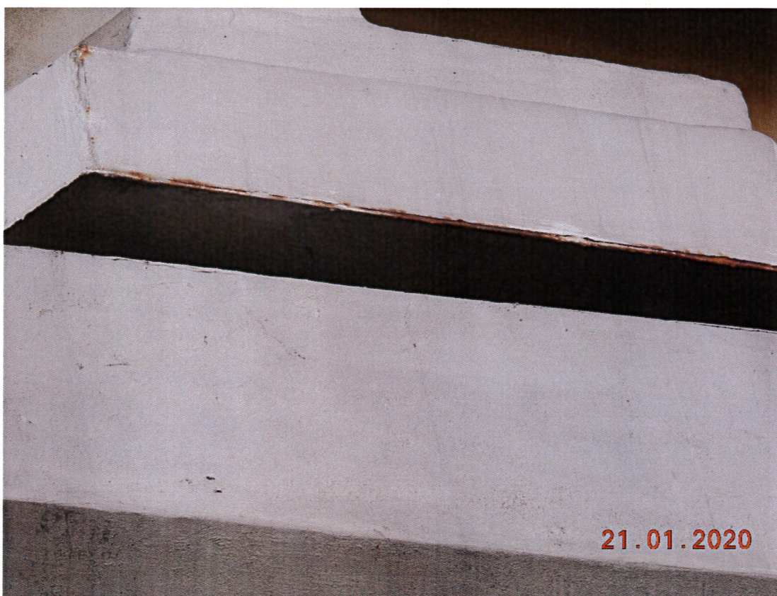
Zdj. 4. Korozja okucia poprzecznicy
