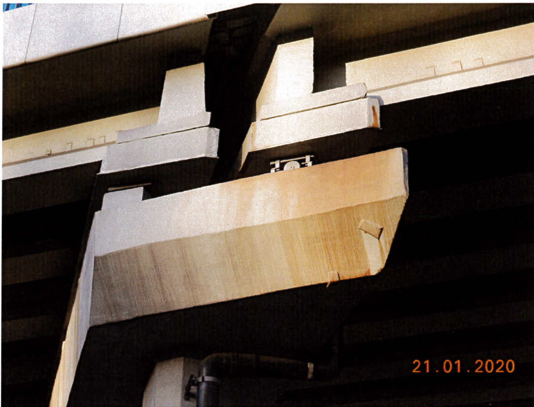
Zdj. 4. Zacieki na oczepie, korozja poprzecznicy
