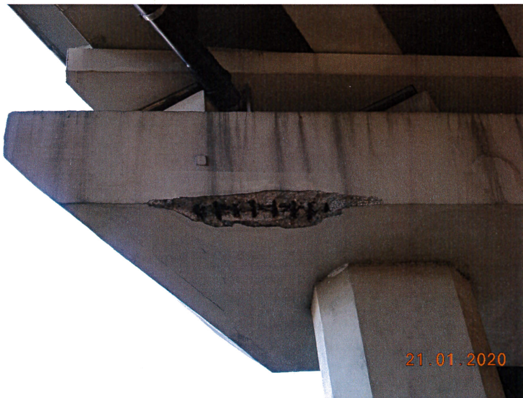
Zdj. 2. Odspojenie betonu oczepu filara, korozja zbrojenia
