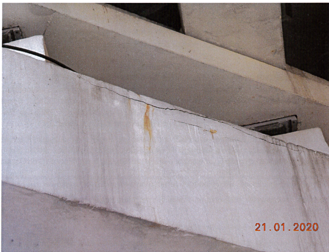
Zdj. 1. Odspojenie betonu oczepu filara, korozja zbrojenia i betonu
