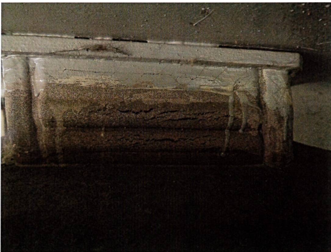
Zdj. 6. Pęknięte łożysko elastomerowe
