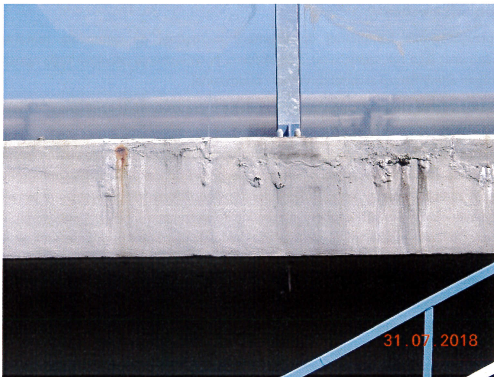
Zdj. 2. Obiekt M12P – przykładowa usterka gzymsu zewnętrznego – korozja zbrojenia i betonu gzymsu
