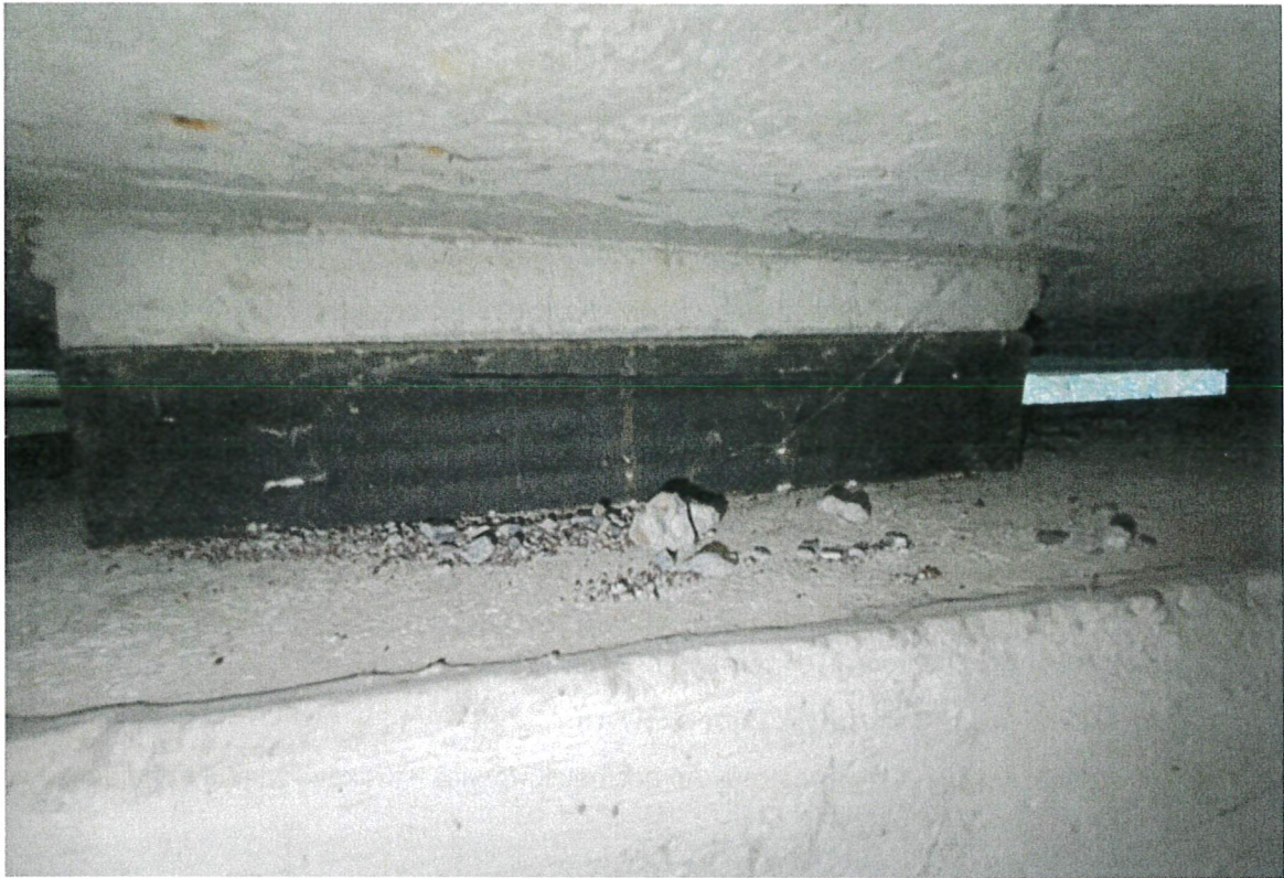
Zdj. 3. Obiekt M54P – łożysko elastomerowe Ł10b.2 przeznaczone do wymiany
