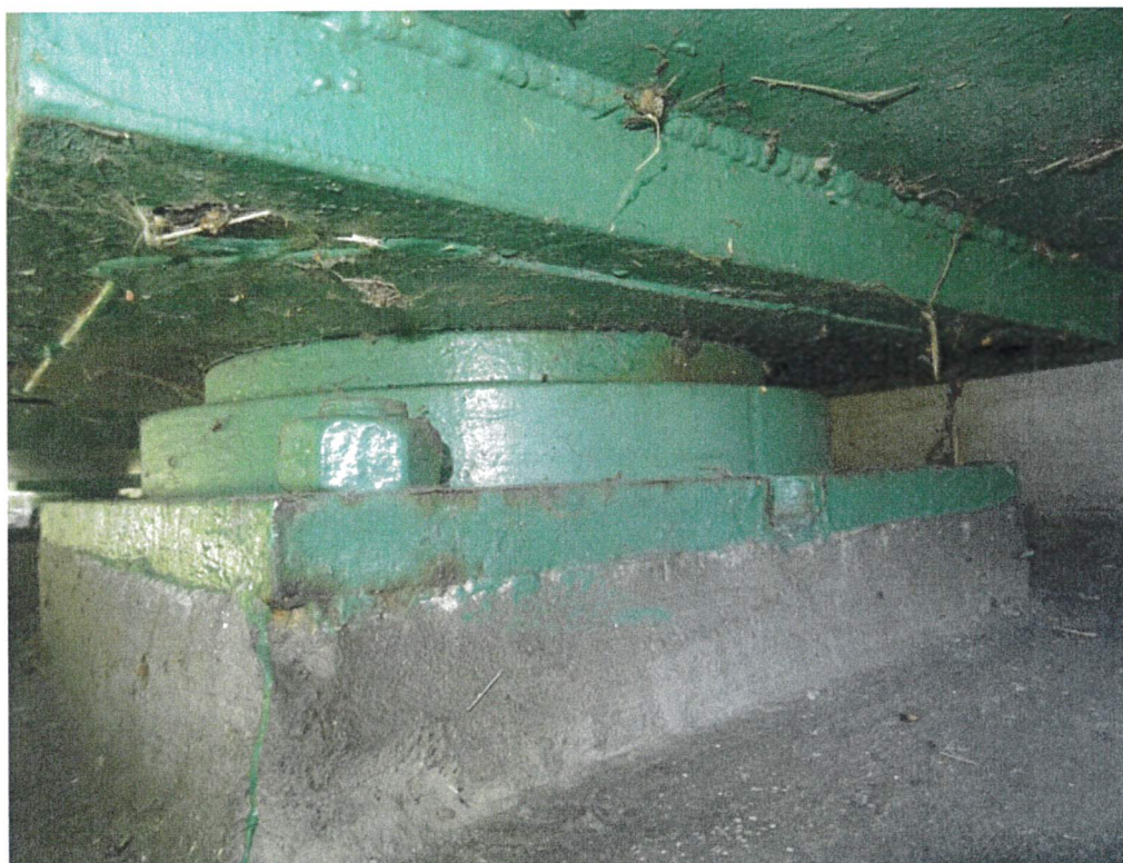
Zdj. 2. Obiekt M24 – łożysko soczewkowe ŁD2 na podporze D. Widoczna korozja elementów stalowych oraz zanieczyszczenia łożyska
