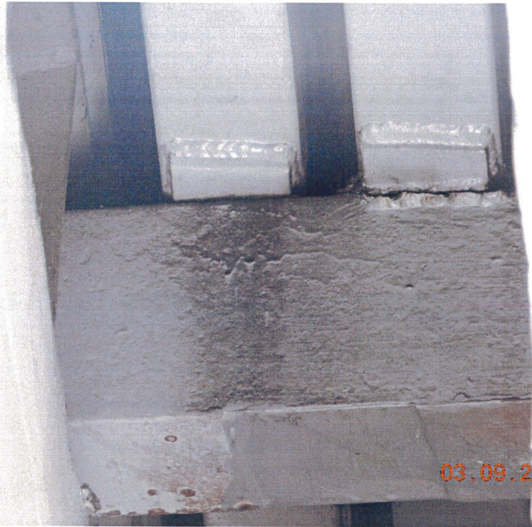
Zdj. 3. Obiekt M02P – zerwane połączenie spawane między przekładką stalową a belką trawersową urządzenia dylatacyjnego od strony Katowic
