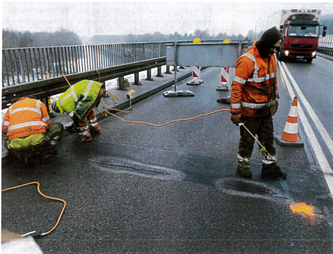
Zdj. 3. Urządzenie dylatacyjne od strony południowej w trakcie napraw w grudniu 2018 r
