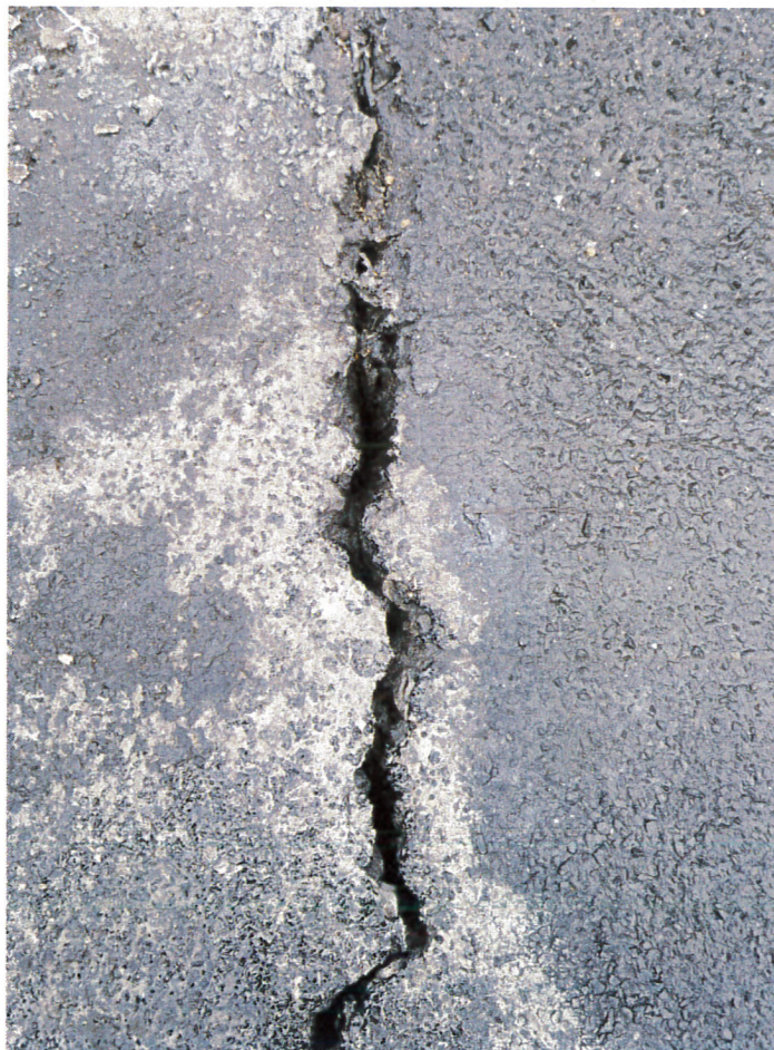
Zdj. 4. Pęknięcie urządzenia dylatacyjnego od strony południowej – widoczne sprężyny urządzenia
