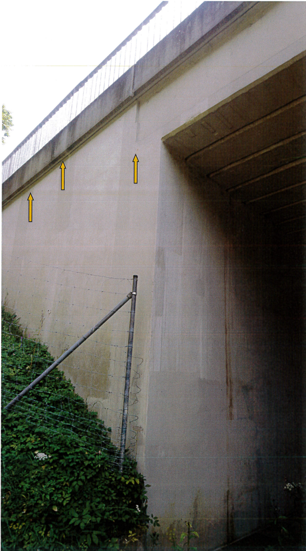
Zdj. 7. Obiekt M47 – osady i zarysowania skrzydła wschodniego i ściany przyczołka wlotu od strony północnej
