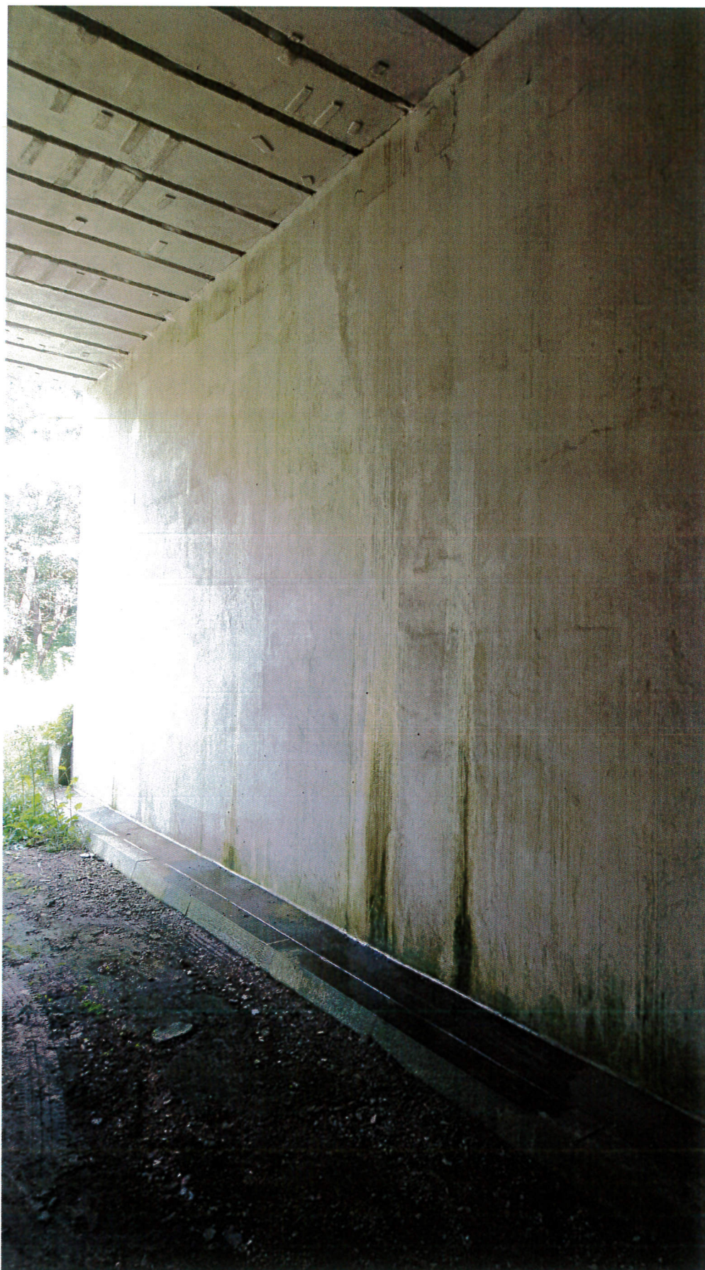
Zdj. 10. Obiekt M47 – ściana przyczółka wschodniego segmentu I – zacieki na ścianie
