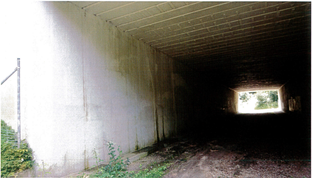
Zdj. 9. Obiekt M47 – ściana przyczółka wschodniego segmentu I – zacieki na ścianie
