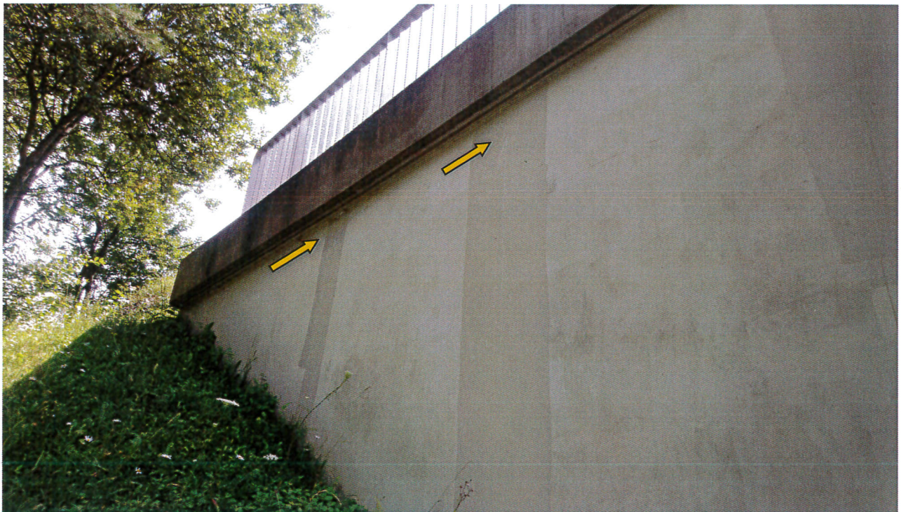
Zdj. 6. Obiekt M47 – osady na skrzydle wschodnim wlotu od strony północnej
