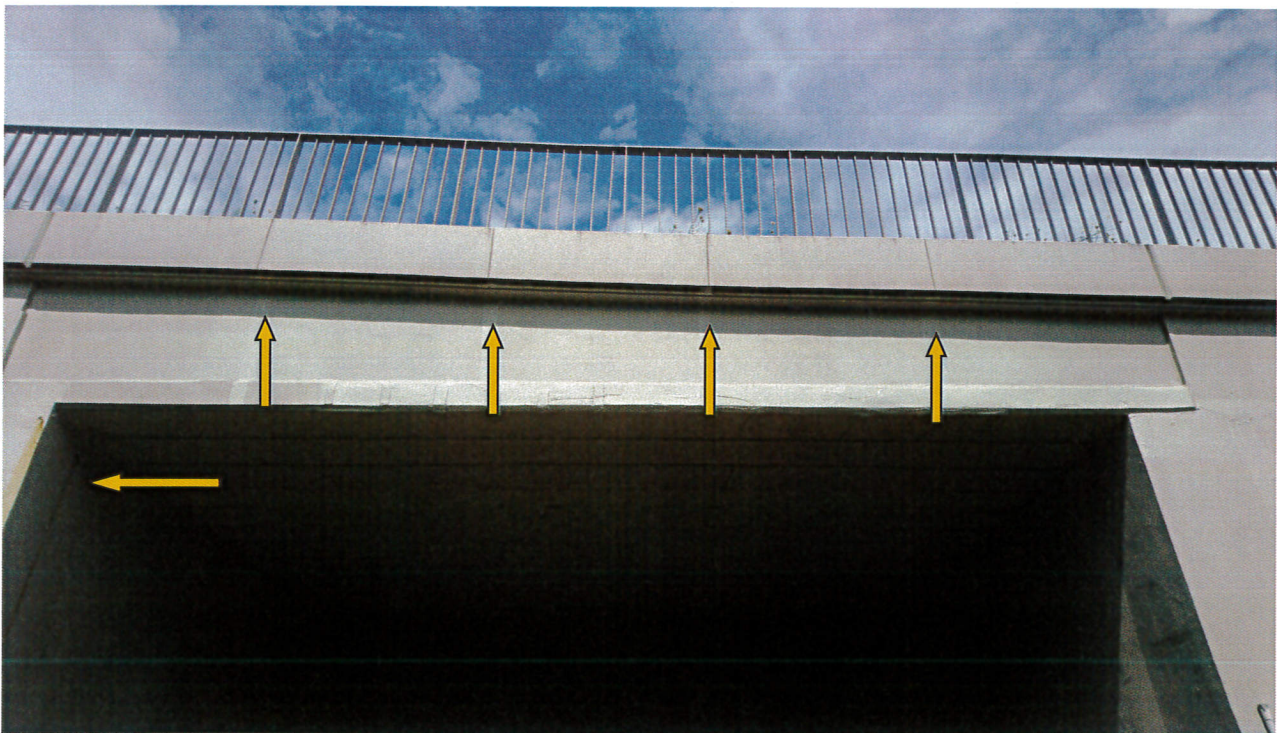
Zdj. 4. Obiekt M47 – osady na powierzchni bocznej rygła od strony południowej i zaciek na ścianie przycółka
