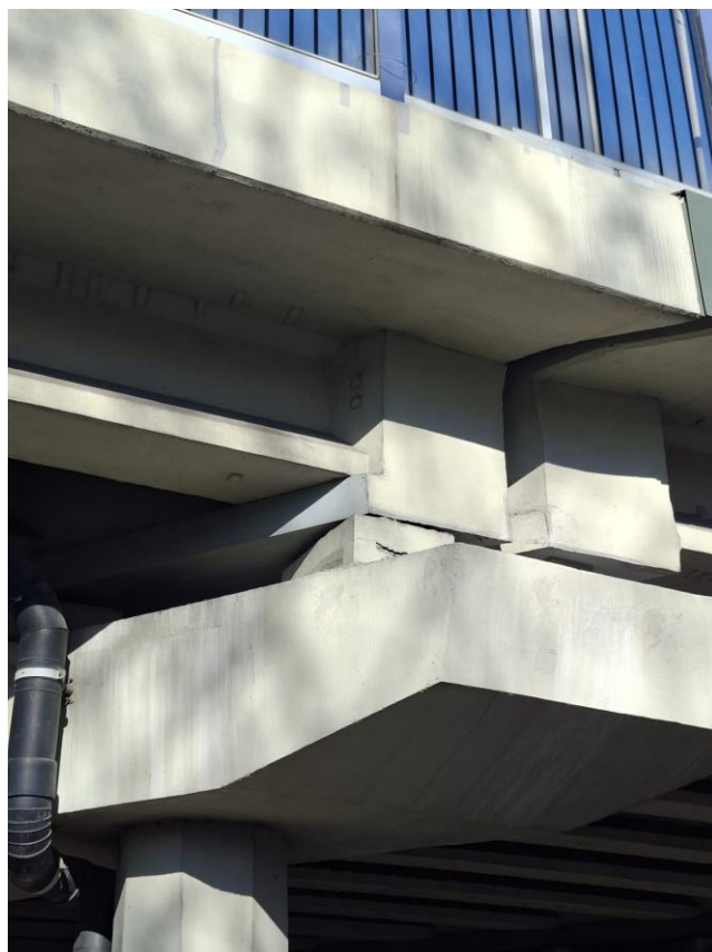
Zdj. 6. Obiekt M11P – spękany cios podłożyskowy
