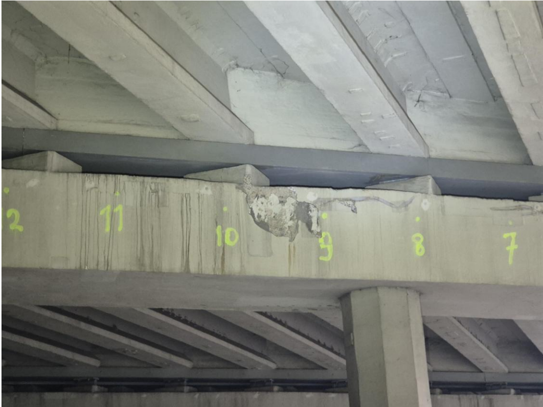
Zdj. 4. Obiekt M11P – odspojenie fragmentu betonu oraz spękania betonu oczepu filara podpory pośredniej
