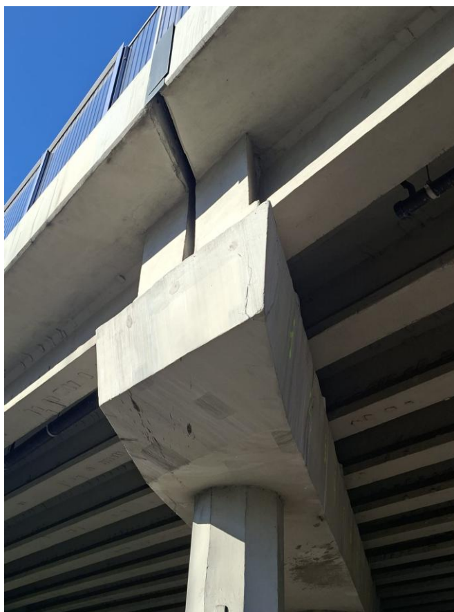
Zdj. 9. Obiekt M11P – spękany beton oczepu podpory pośredniej
