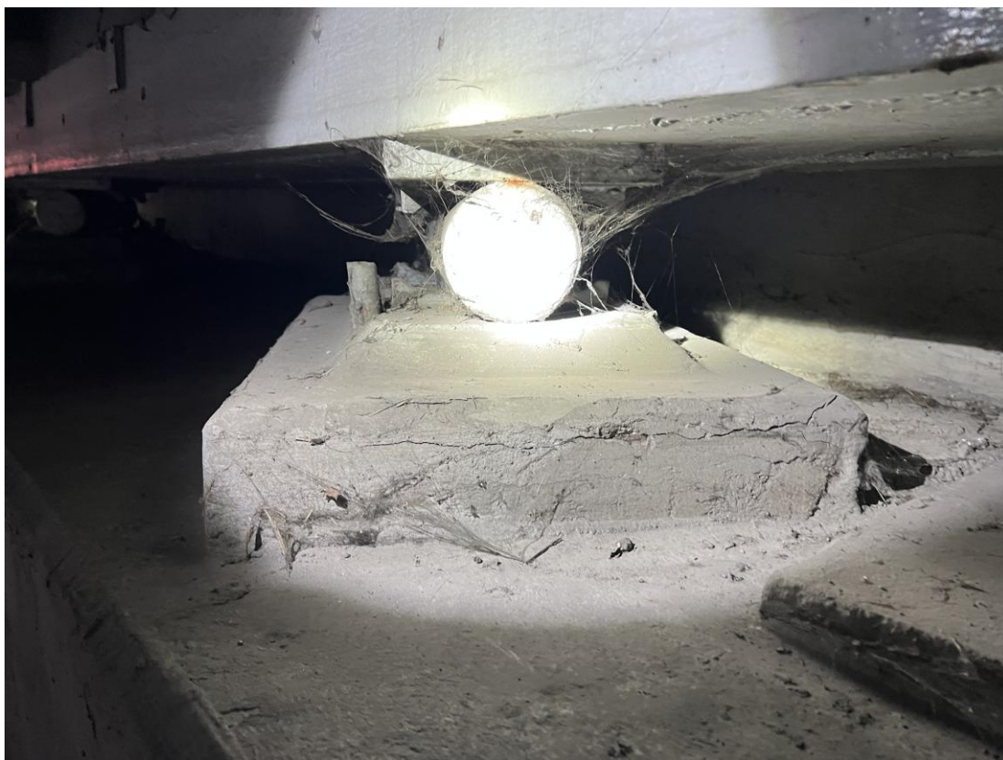
Zdj. 8. Obiekt M11L – spękany cios podłożyskowy; punktowa korozja łożyska wałkowego
