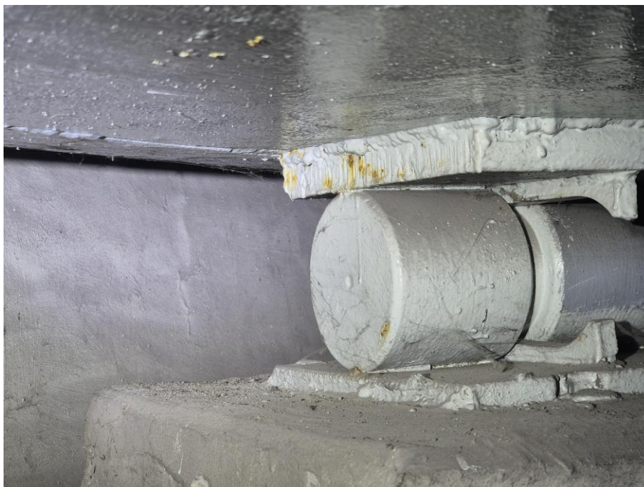
Zdj. 1. Obiekt M11P – punktowa korozja elementów stalowych łożyska wałkowego
