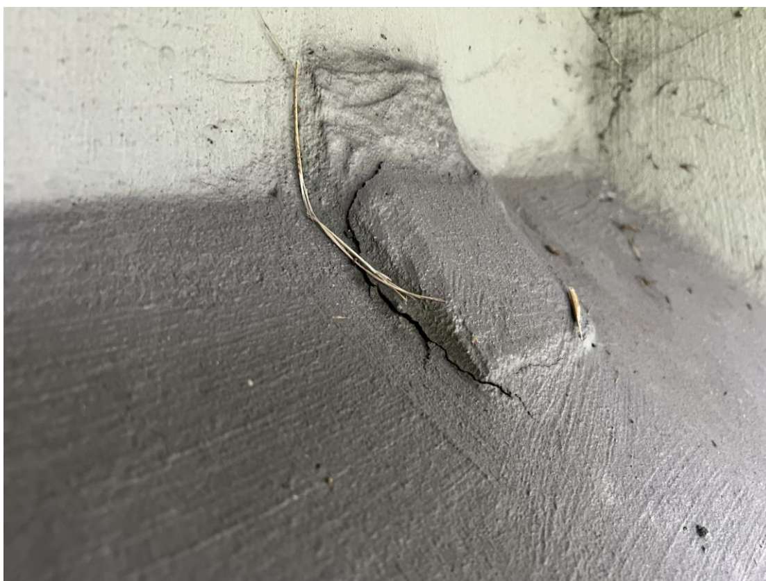
Zdj. 7. Obiekt M11L – spękanie warstwy naprawczej dźwigara
