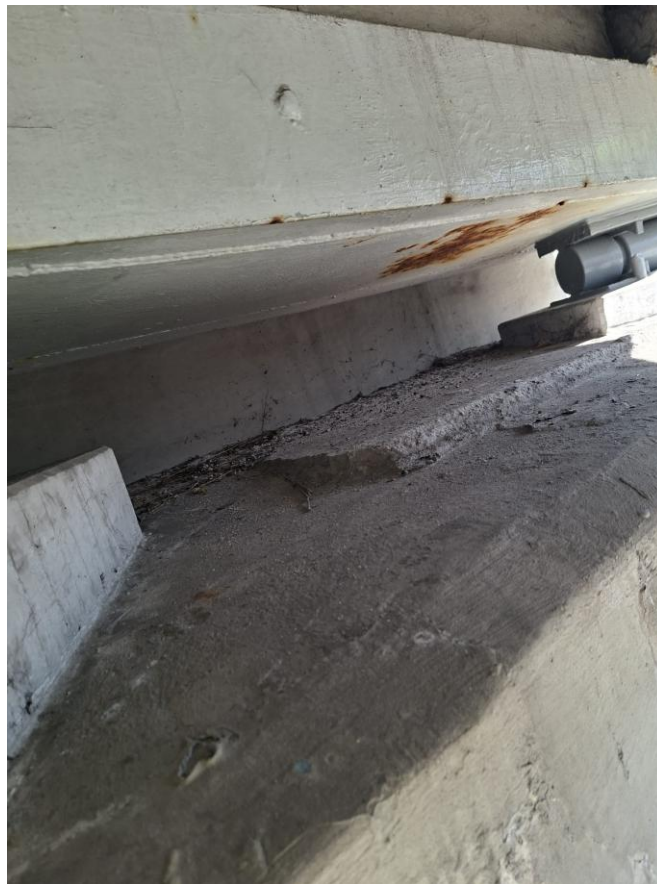
Zdj. 5. Lokalne ognisko korozji okucia poprzecznicy (przykład)
