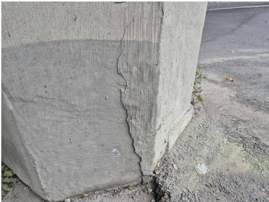
Zdj. 2. Obiekt M11P – odspojenie betonu słupa podpory pośredniej
