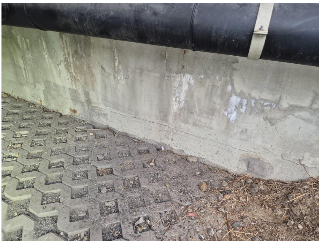
Zdj. 3. Obiekt M11P – zarysowania betonu i wyługowania oraz lokalna korozja stali zbrojeniowej podpory skrajnej
