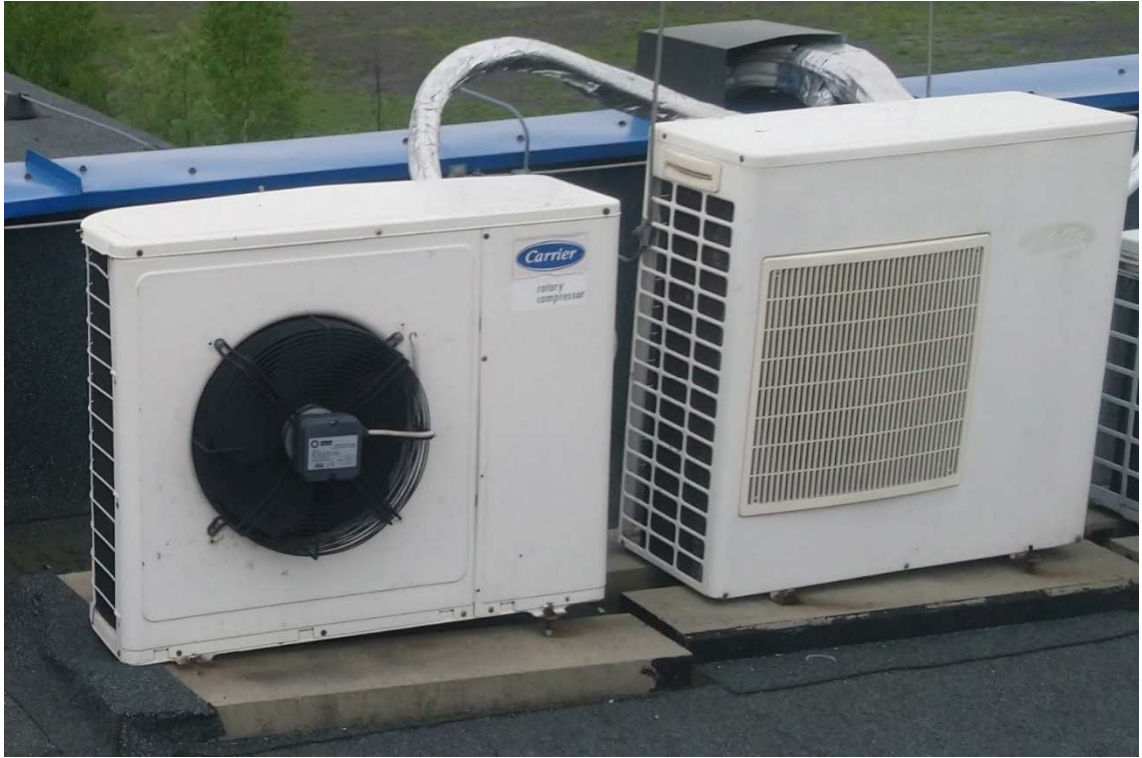
Zdjęcie nr 5 - jednostki zewnętrzne na dachu do biur 1.01, 1.02 oraz 1.03, 1.04, 1.06, 1.21b
