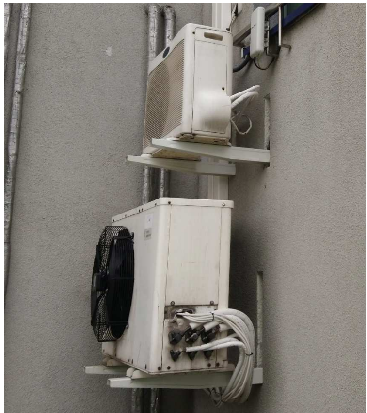
Zdjęcie nr 4 – jednostki zewnętrzne do biur 1.11, 1.12, 1.13 oraz 1.19
